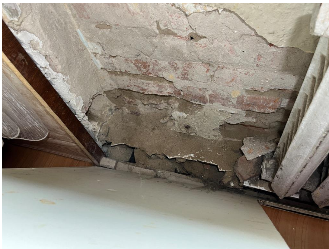
Фото 8. Переувлажнение кладки стен, выветривание раствора по оси К/7-8 1 этаж
