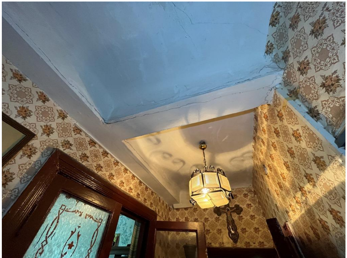
Фото 30. Прогиб перекрытия, в осях Г-Д/2-3 1 этаж
