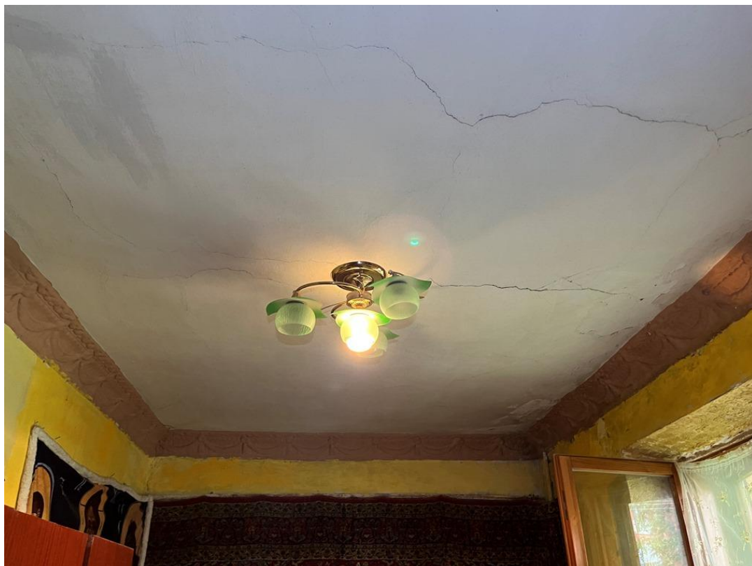
Фото 33. Прогиб перекрытия, в осях Б-Г/1-2 1 этаж
