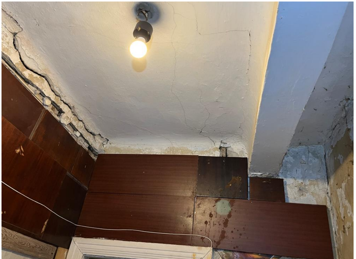
Фото 20. Прогиб перекрытия, в осях Е-И/2-3 1 этаж
