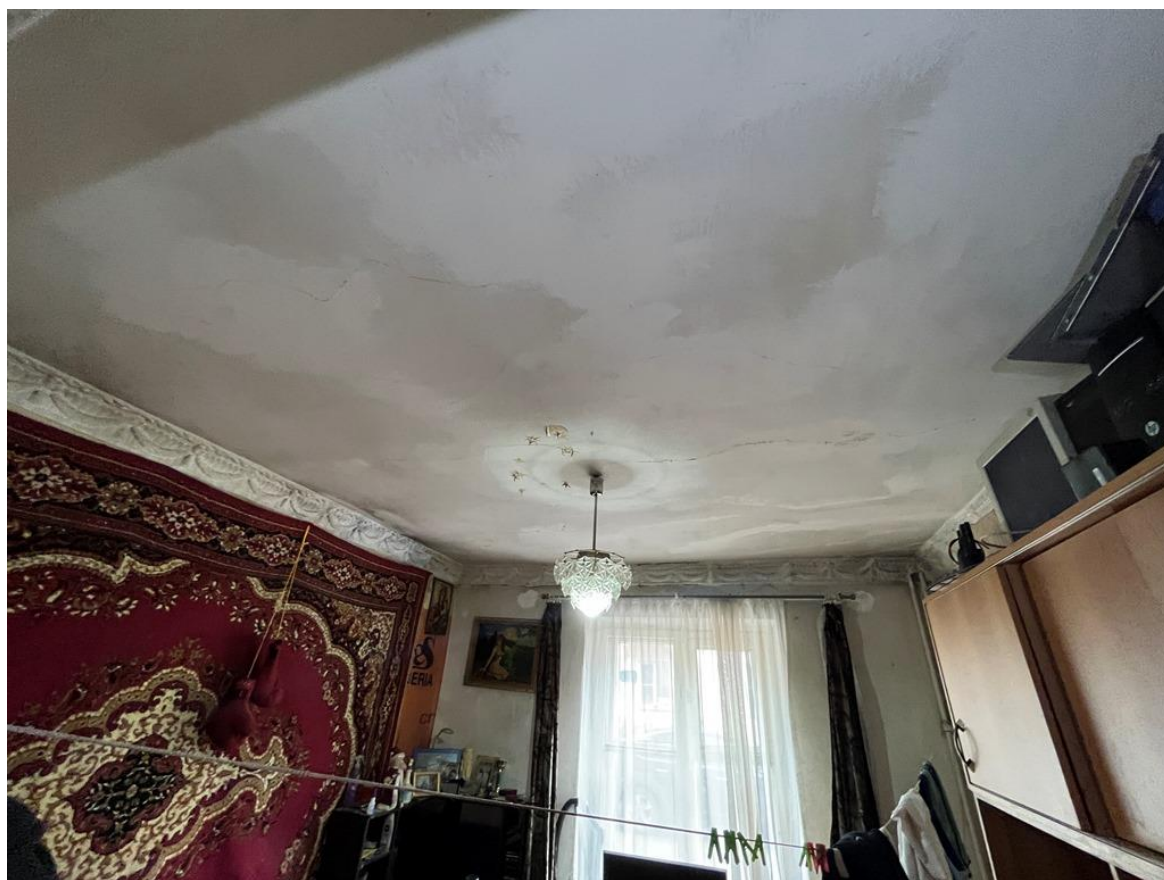
Фото 18. Прогиб перекрытия, в осях И-Л/2-3 1 этаж
