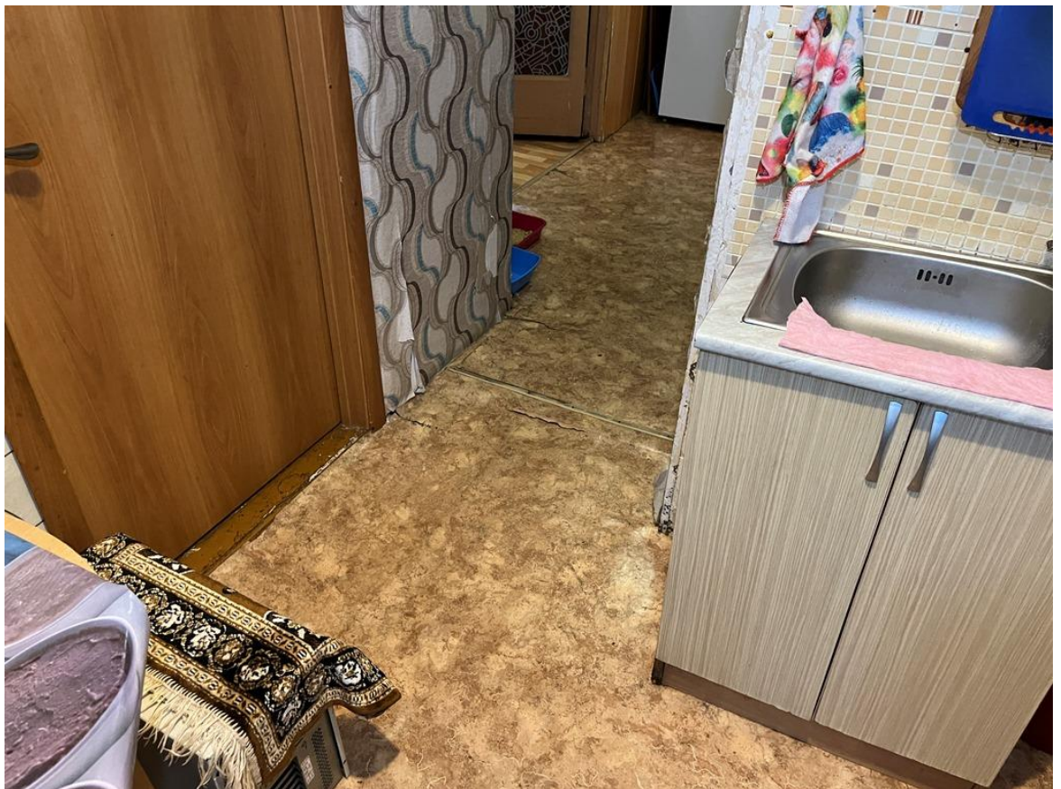
Фото 16. Прогобы, зыбкость пола в осях Б-Г/9-10 1 этаж
