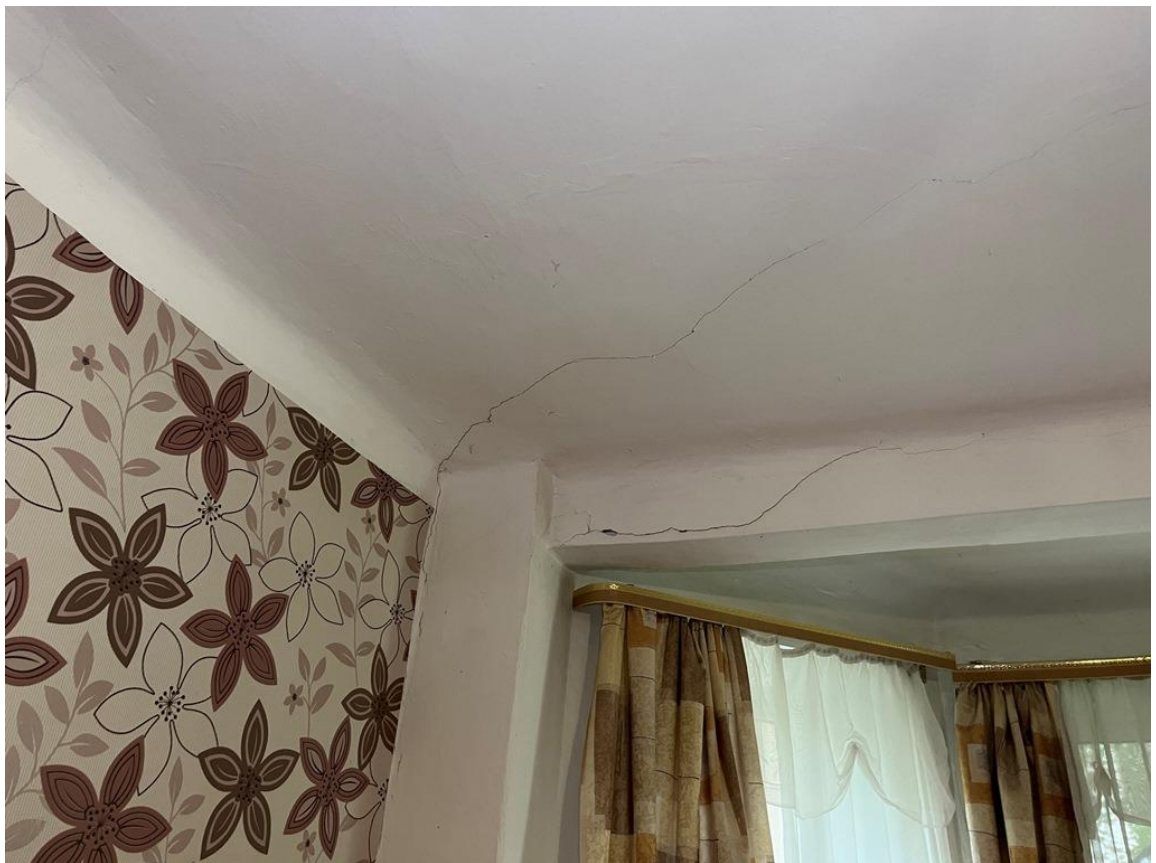
Фото 12. Прогиб перекрытия, разрушение балки перекрытия, в осях Б-Г/9-10 1 этаж
