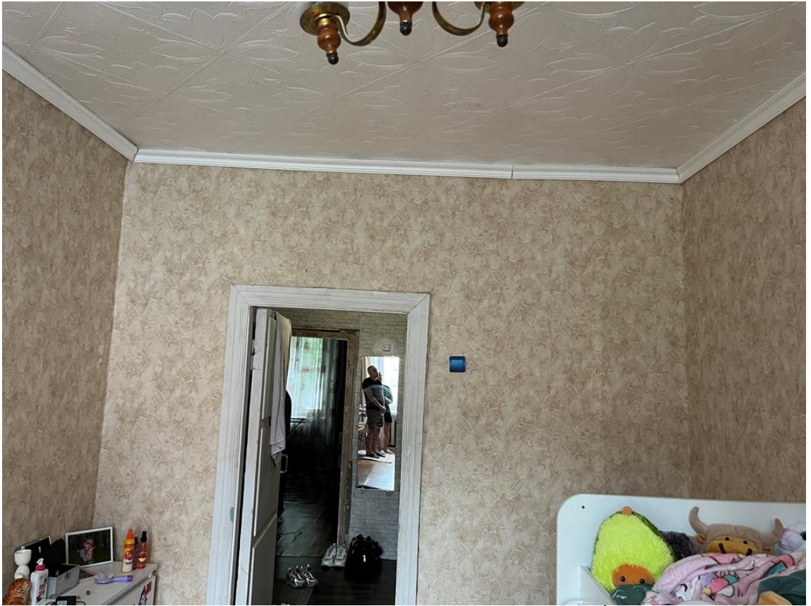
Фото 9. Деформация перегородки по оси Ж/7-8 1 этаж
