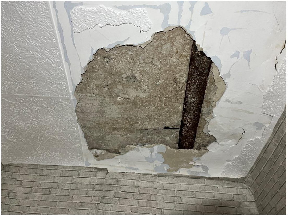
Фото 5. Отслоение защитного слоя, коррозия арматуры ж.б. перекрытия в осях Е-Ж/6-7 1 этаж
