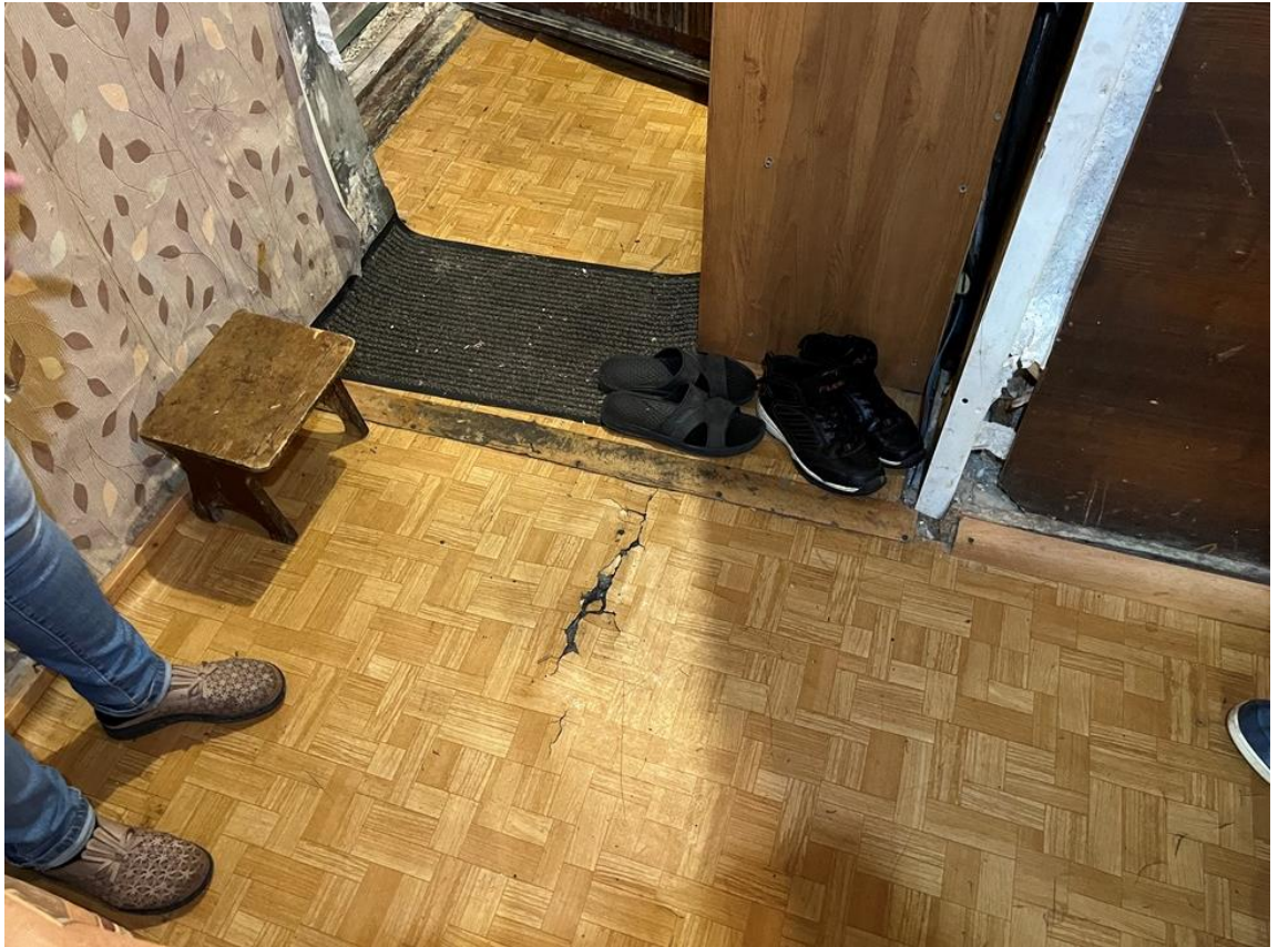
Фото 21. Прогитбы, зыбкость пола в осях Е-И/2-3 1 этаж
