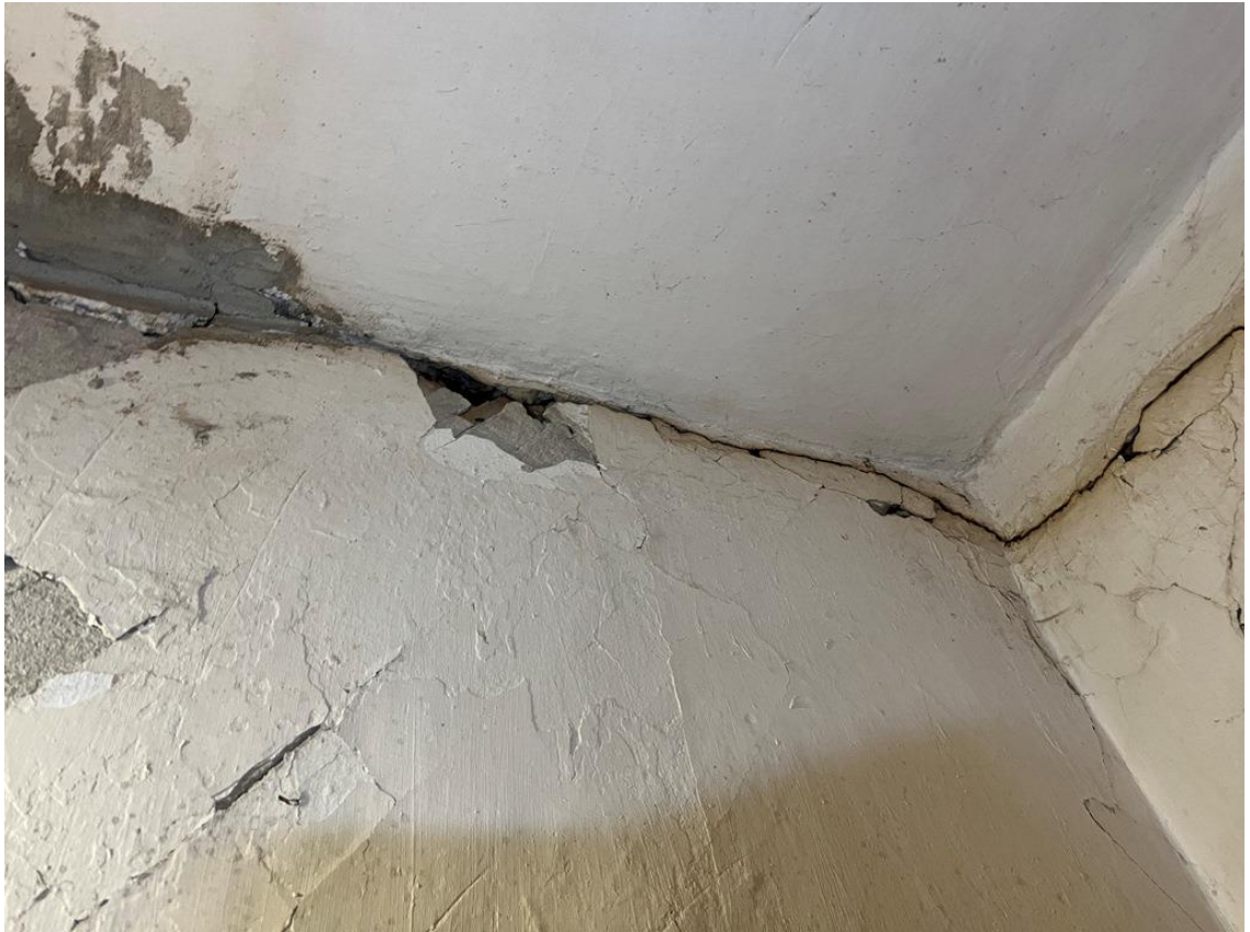
Фото 23. Деформация перегородки в осях Е-И/2-3 1 этаж
