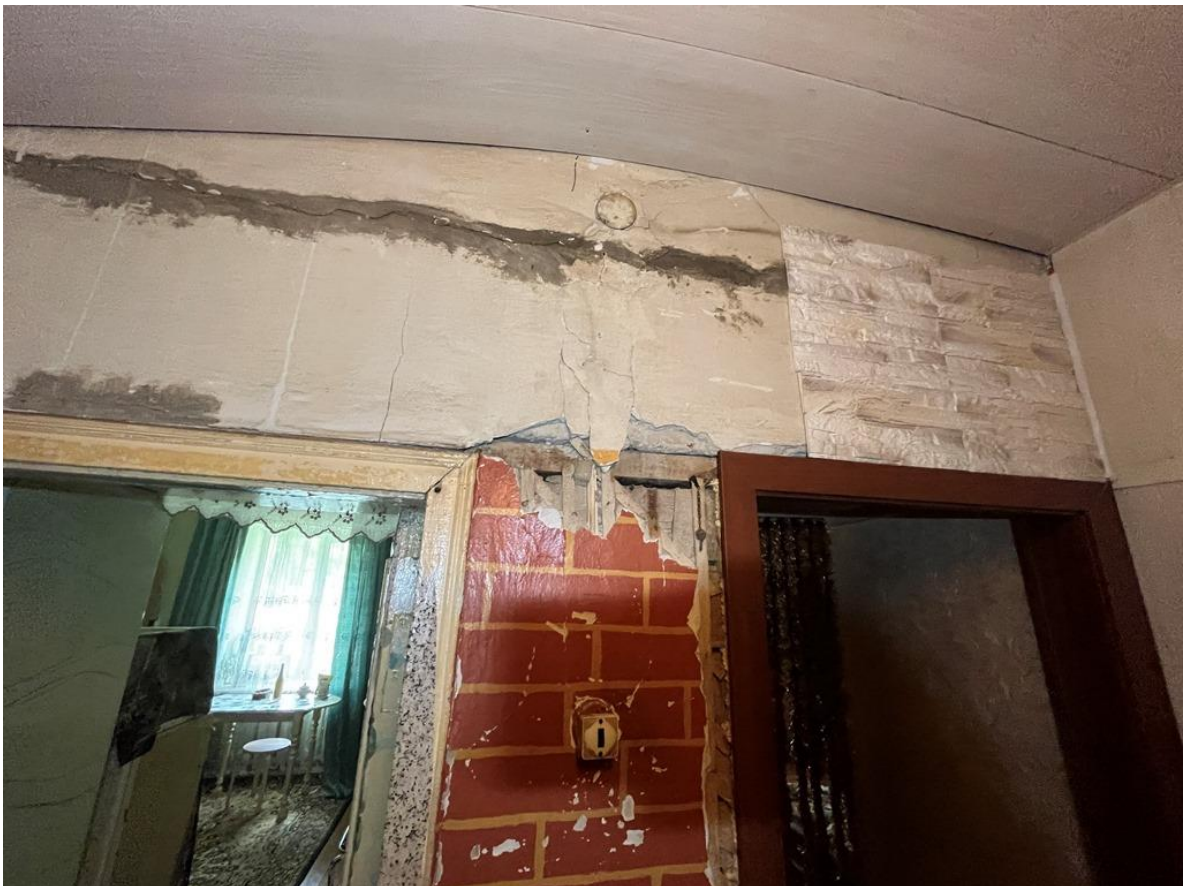
Фото 26. Деформация перегородки в осях Д-Е/4-5 1 этаж
