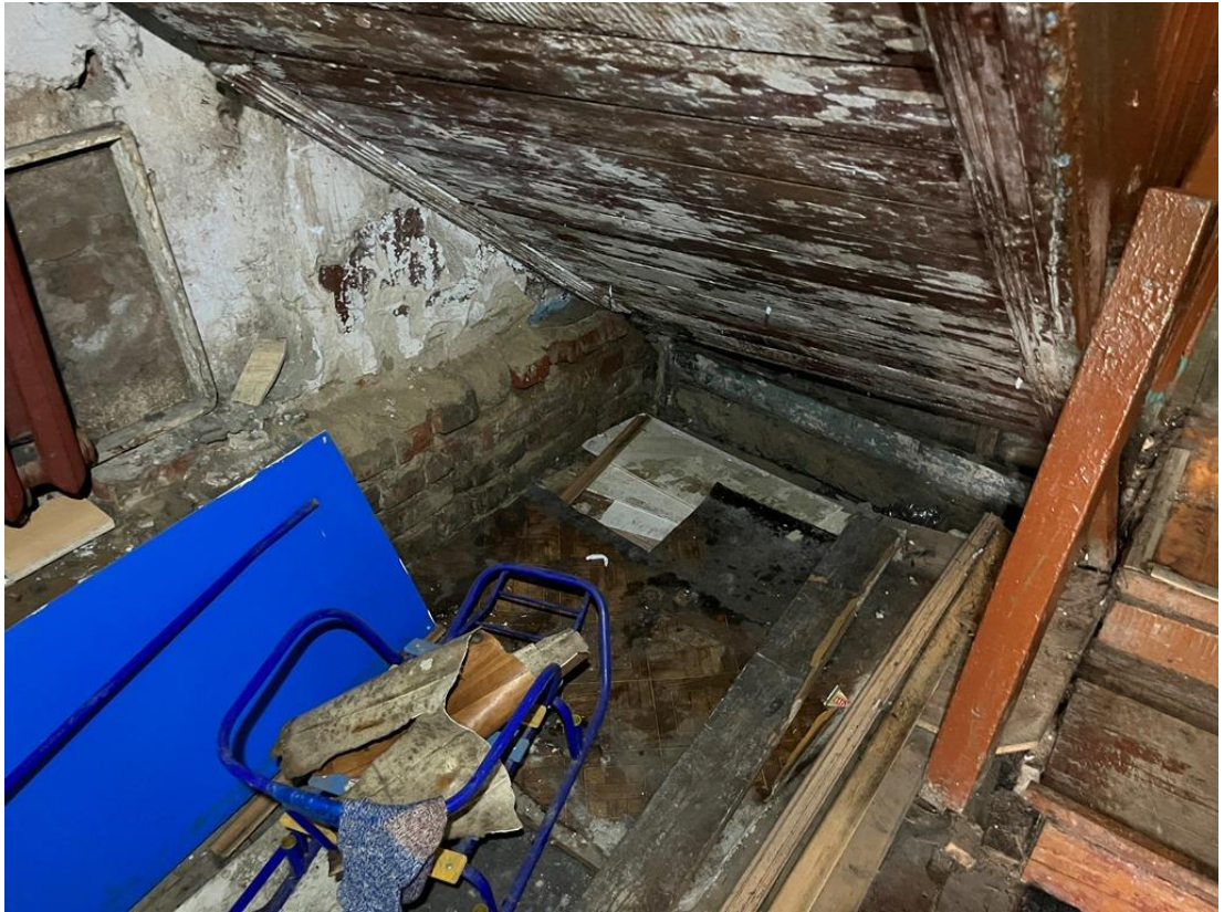
Фото 45. Переувлажнение поперечной несущей стены по оси 4 /И-К
