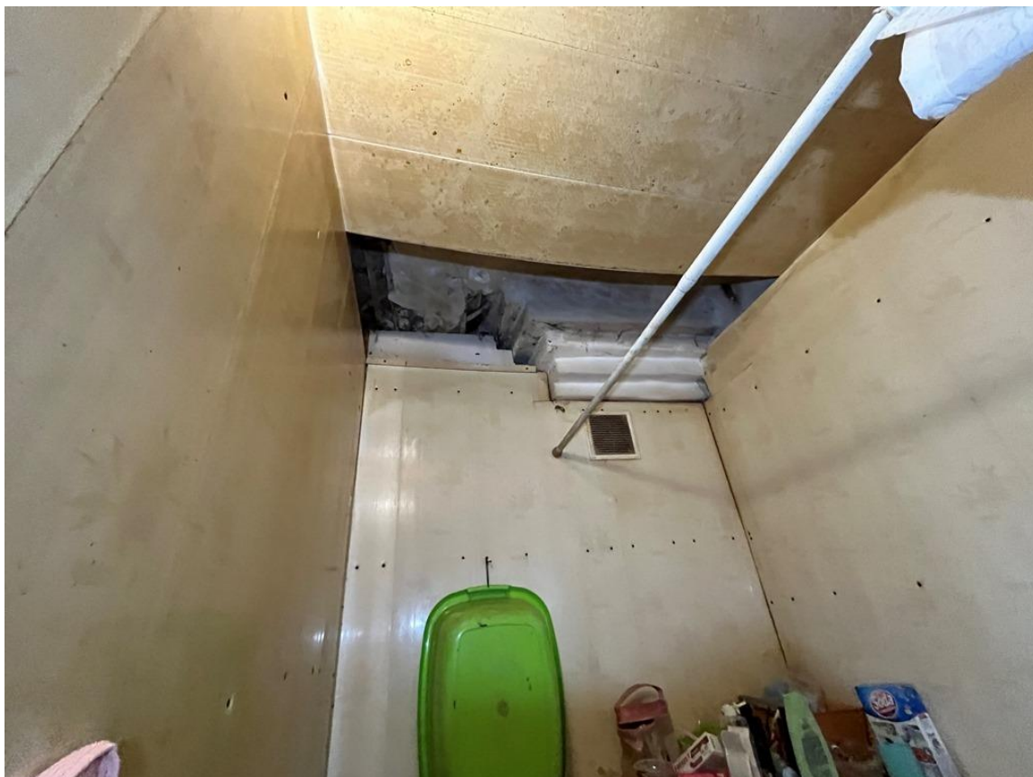
Фото 35. Замачивание перекрытия в осях Г-Е /1-3 2 этаж
