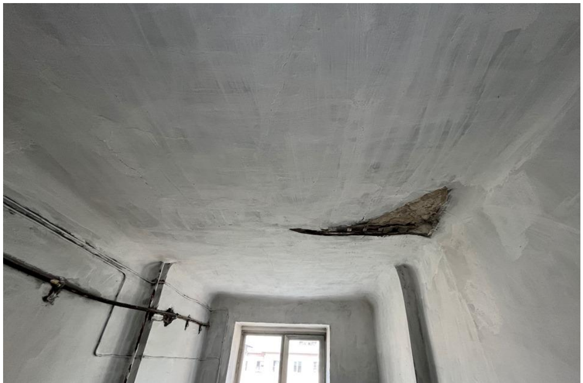
Фото 44. Прогиб перекрытия, в осях Д-К/8-9 2 этаж
