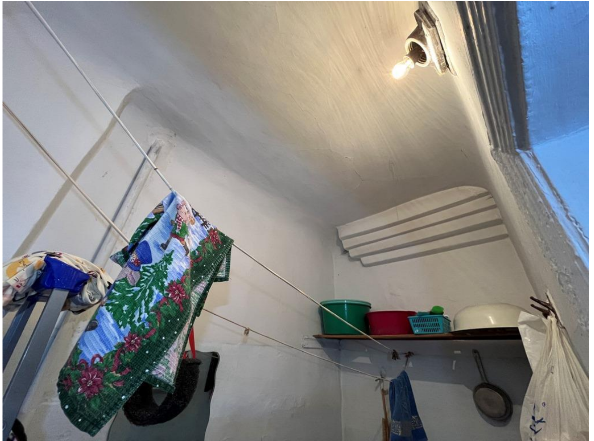
Фото 41. Прогиб перекрытия, в осях Е-Ж/6-7 2 этаж
