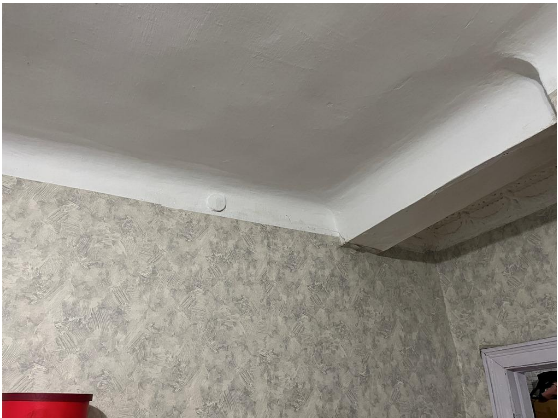
Фото 2. Прогиб балки по оси Д/7-8 1 этаж
