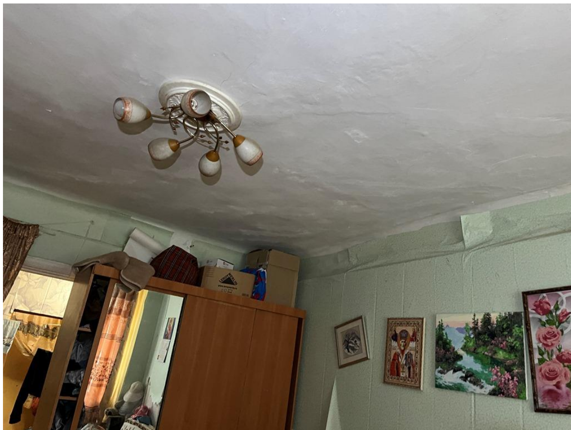
Фото 39. Прогиб перекрытия, в осях Б-Г/2-3 2 этаж
