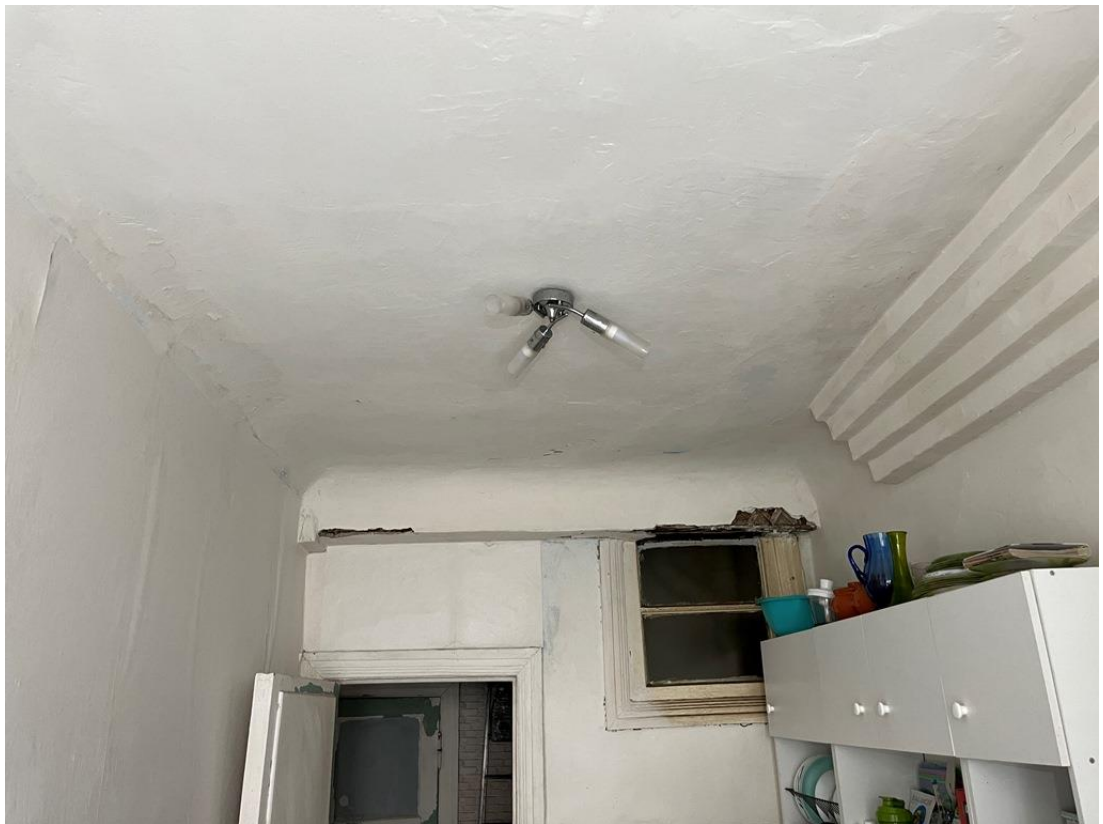
Фото 6. Прогиб перекрытия, балки перекрытия, в осях Ж-К/6-7 1 этаж
