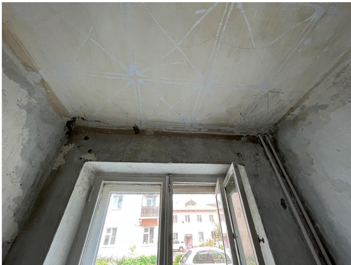
Фото 27. Прогиб перекрытия, в осях Ж-К/5-6 1 этаж
