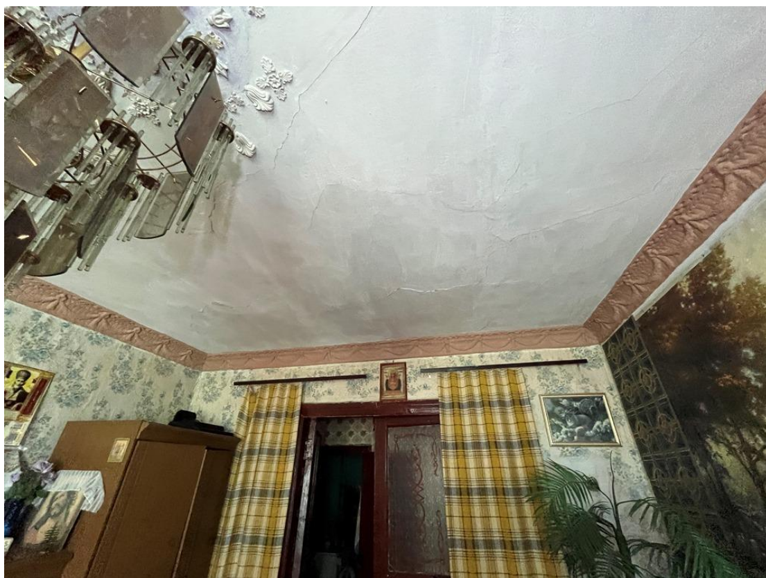
Фото 32. Прогиб перекрытия, в осях Б-Г/2-3 1 этаж
