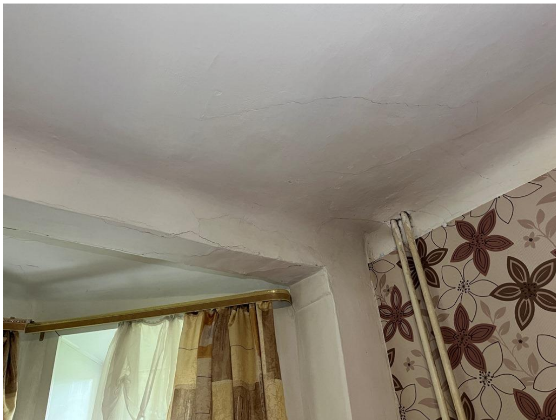
Фото 13. Прогиб перекрытия, балки перекрытия, в осях Б-Г/9-10 1 этаж
