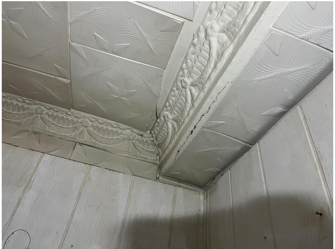
Фото 38. Прогиб перекрытия, в осях В-Г/1-2 2 этаж
