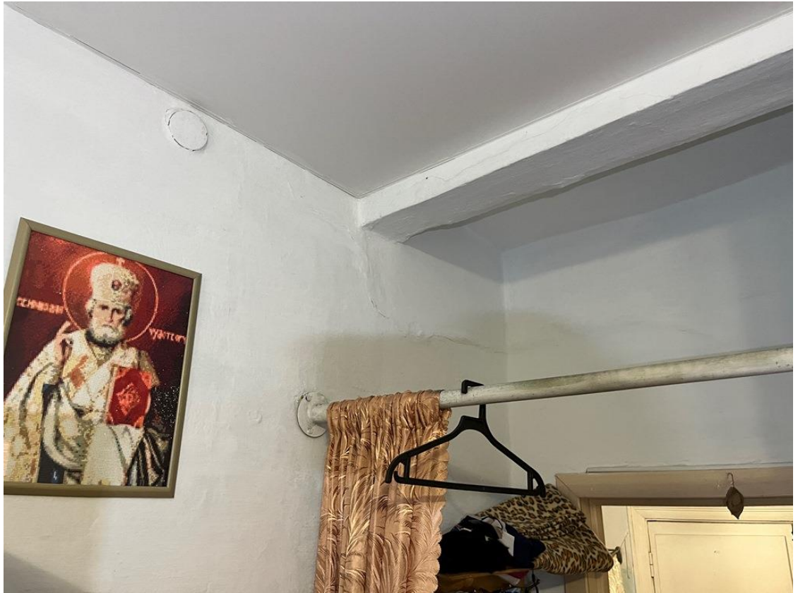
Фото 43. Деформация перегородки в осях Б-Г/7-8 2 этаж
