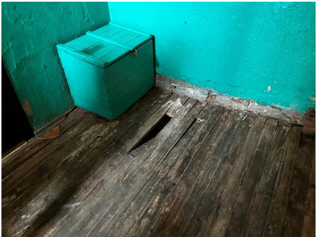
Фото 46. Зыбкость, разрушение пола в осях Д-Ж/З-4 2 этаж
