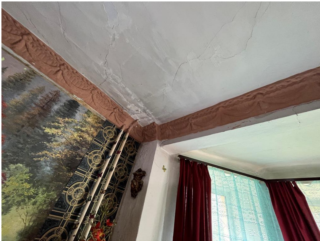
Фото 31. Прогиб перекрытия, в осях Б-Г/2-3 1 этаж
