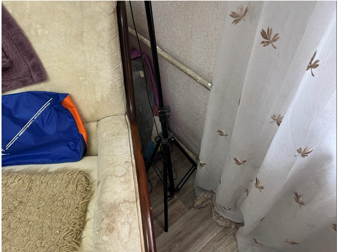
Фото 3. Увлажненная кладка, отслоение отделки в осях В-Д/7-9 1 этаж
