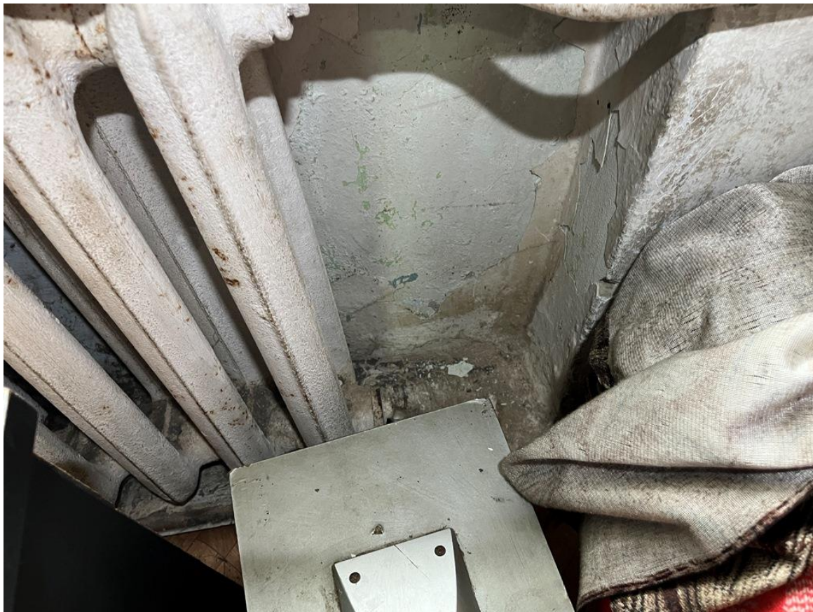
Фото 17. Переувлажнение кладки стен, по оси Л/2-3 1 этаж
