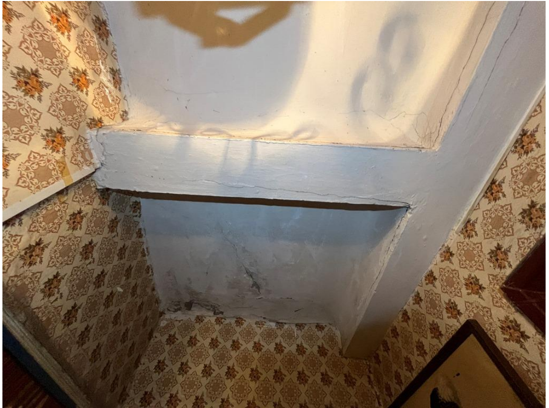
Фото 29. Прогиб перекрытия, в осях Г-Д/2-3 1 этаж
