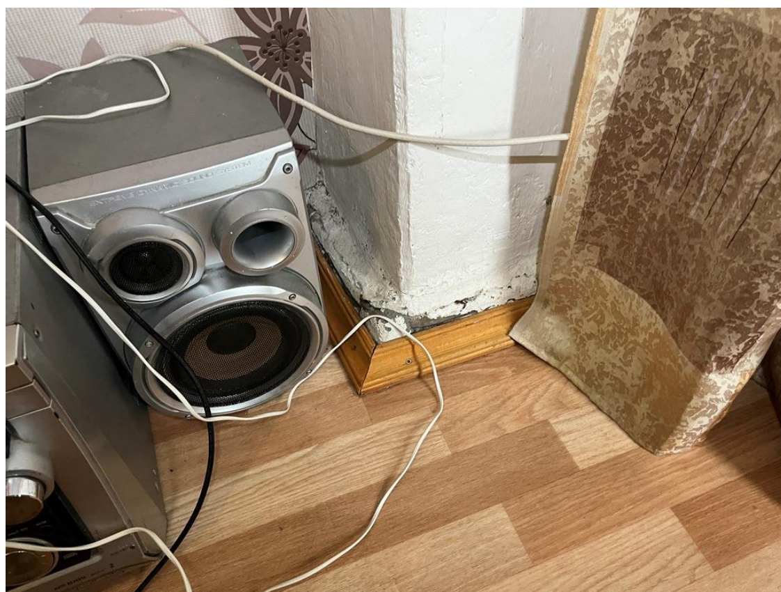
Фото 14. Переувлажнение кладки стен в осях Г-Е/10-11 1 этаж
