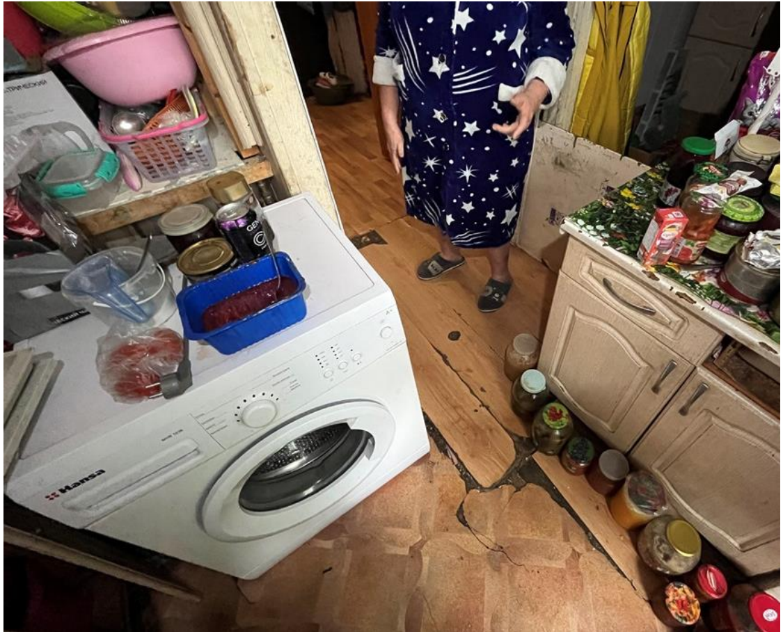
Фото 37. Зыбкость пола в осях Г-Е /1-3 2 этаж
