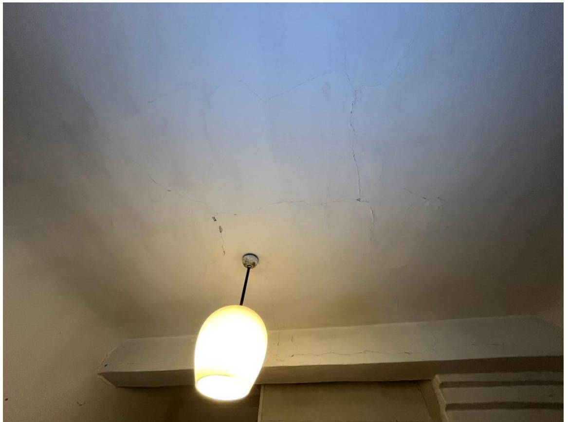
Фото 15. Прогиб перекрытия, разрушение балки перекрытия, в осях Б-Г/9-10 1 этаж
