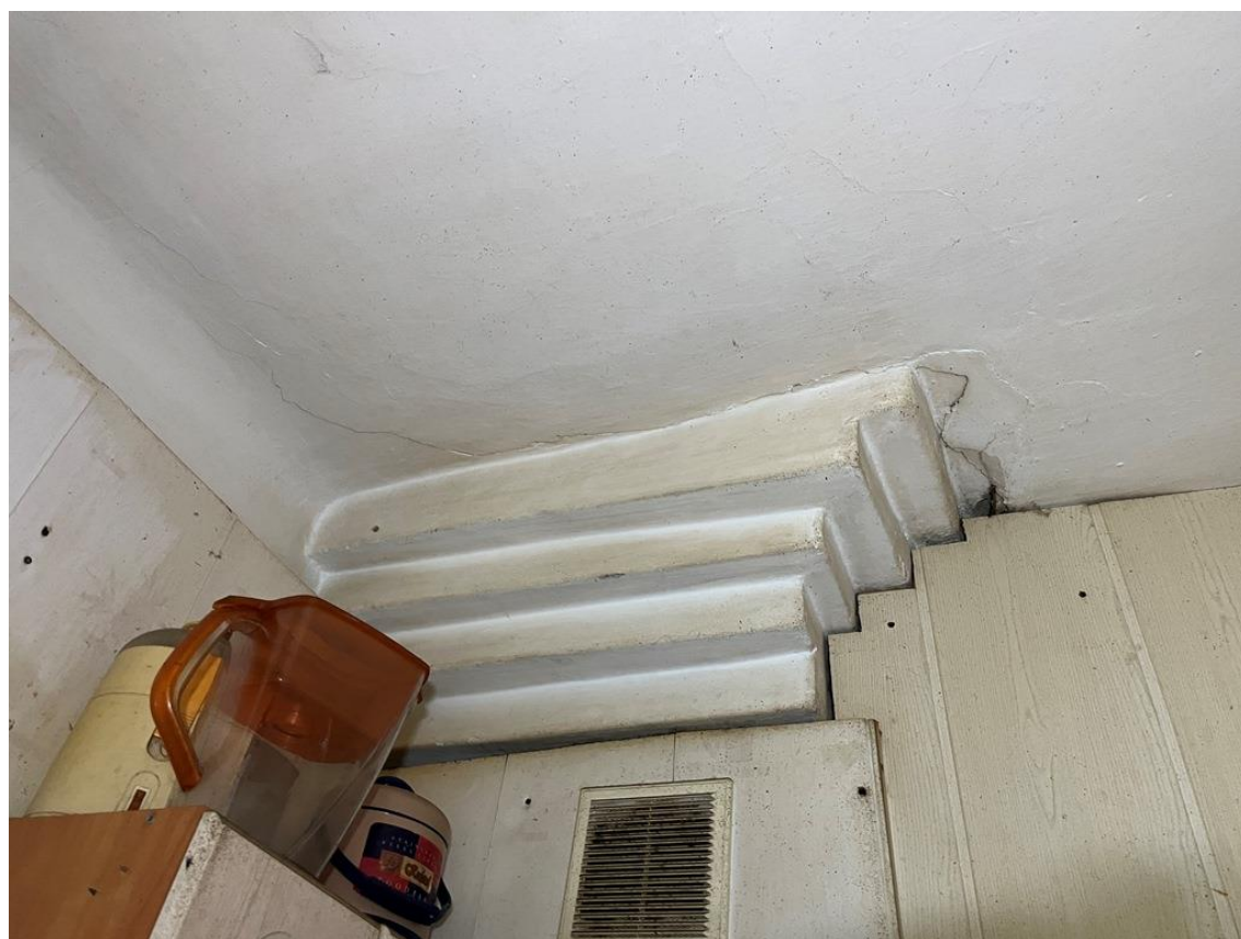
Фото 36. Прогиб перекрытия, в осях Г-Е /1-3 2 этаж
