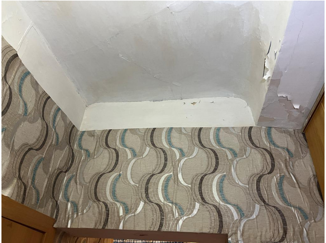
Фото 11. Замачивание стены по оси по оси 10/Г-Д 1 этаж
