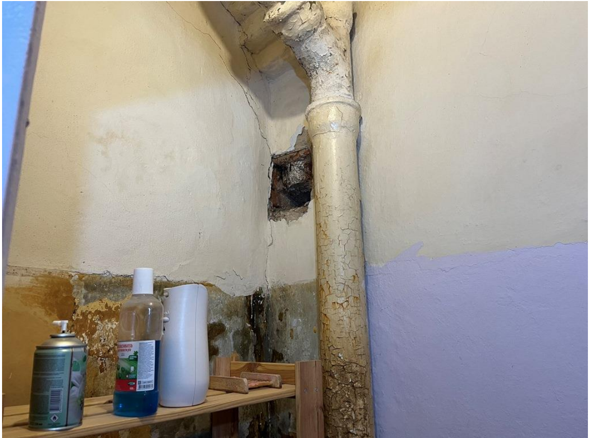
Фото 10. Замачивание стены по оси 6/Е-Ж 1 этаж
