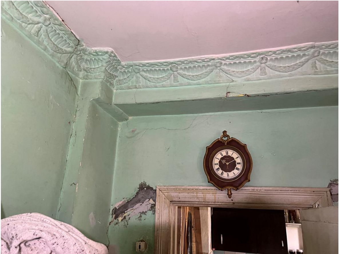
Фото 25. Прогиб перекрытия, в осях И-К/1-2 1 этаж
