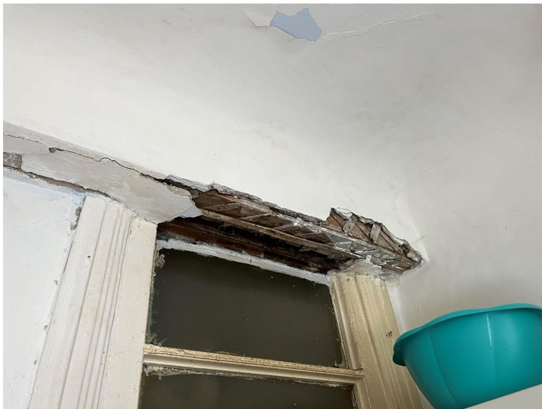
Фото 7. Прогиб перекрытия, балки перекрытия, в осях Ж-К/6-7 1 этаж
