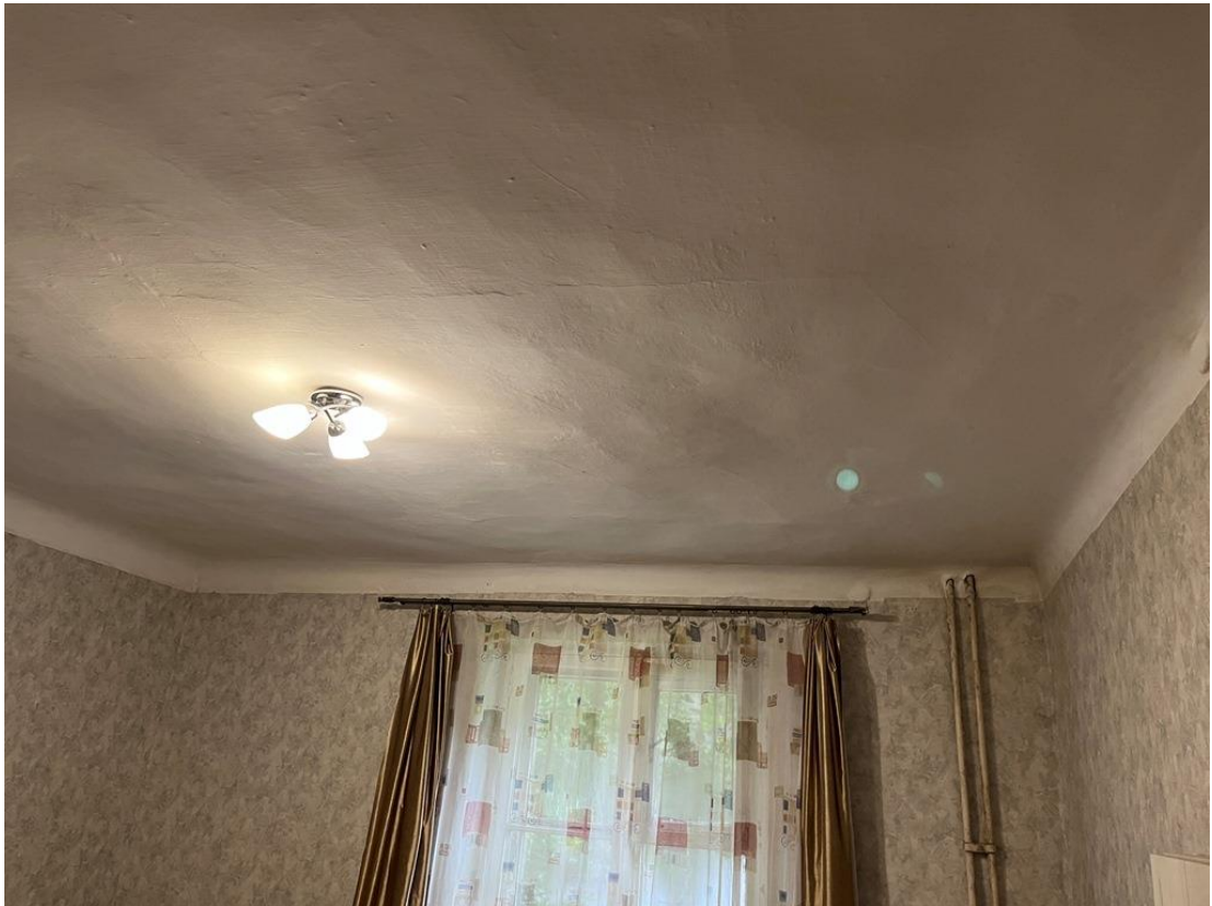
Фото 1. Прогибы перекрытия в осях Д-В/7-8 1 этаж
