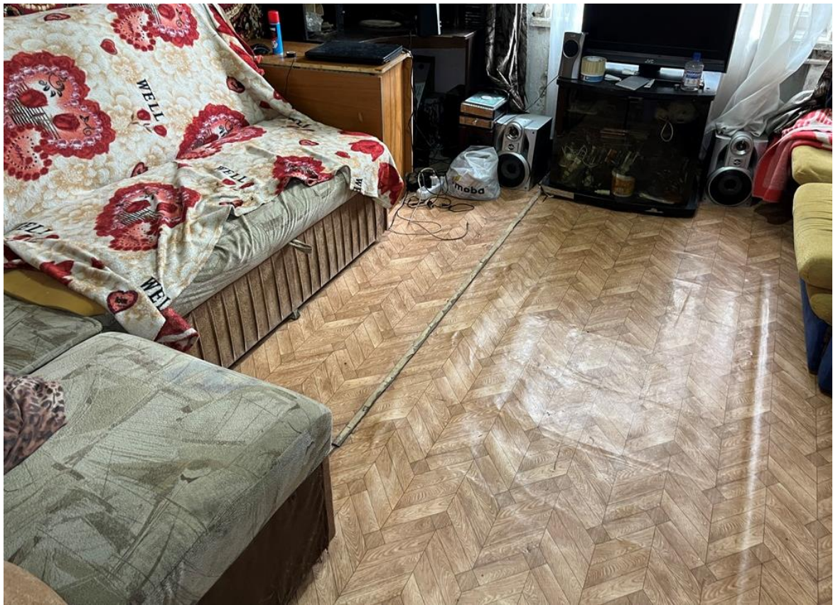
Фото 19. Прогобы, зыбкость пола, в осях И-Л/2-3 1 этаж
