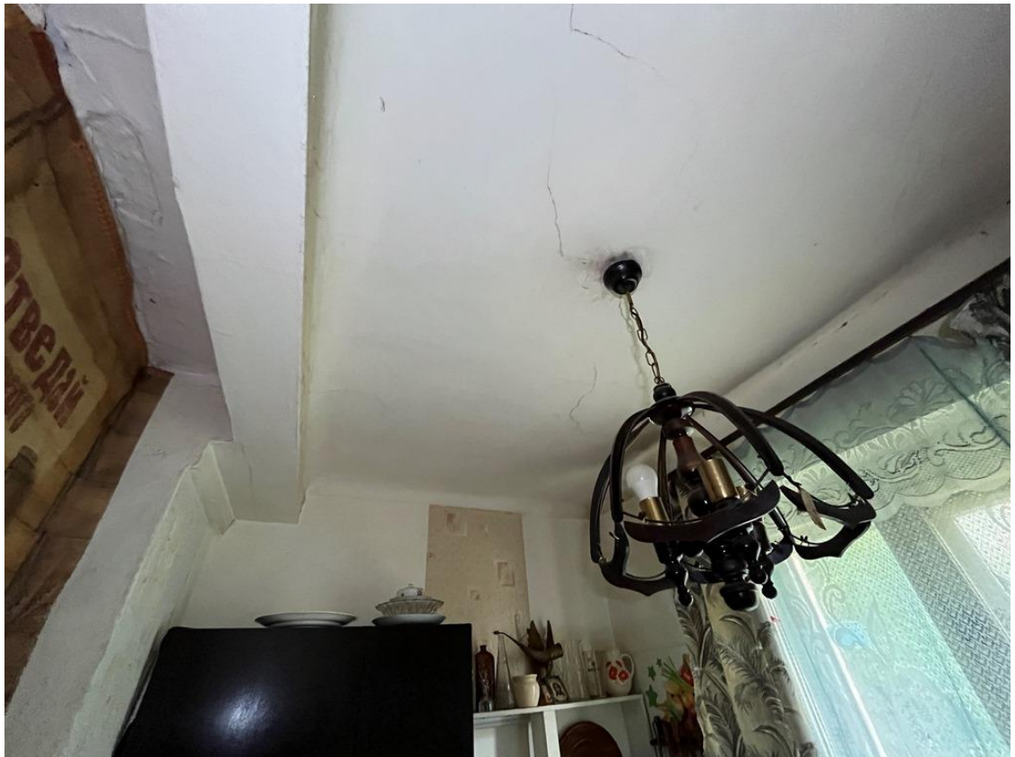
Фото 24. Прогиб перекрытия, в осях Е-И/1-2 1 этаж
