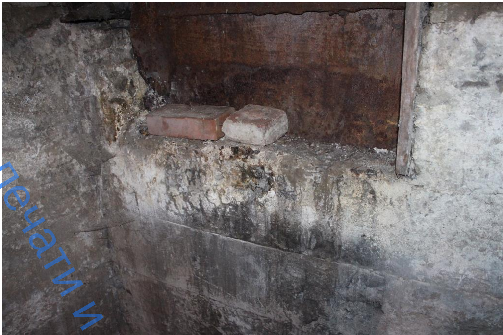
Фото 3. Промораживание стен подвала.
