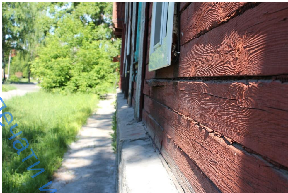
Фото 23. Фасад ось А
