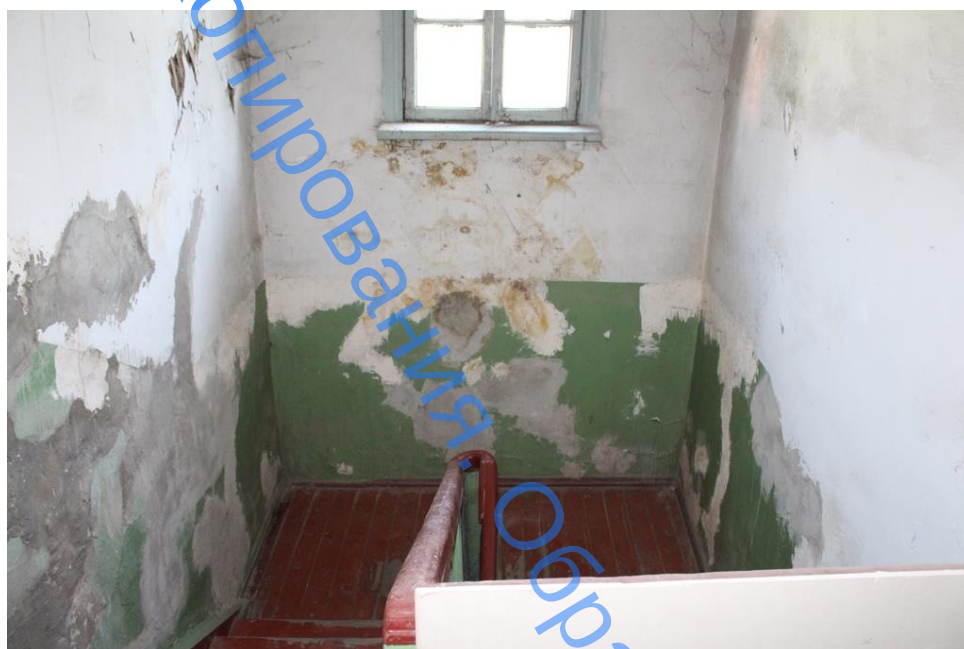
Фото 28. Промерзание по стене Гс
