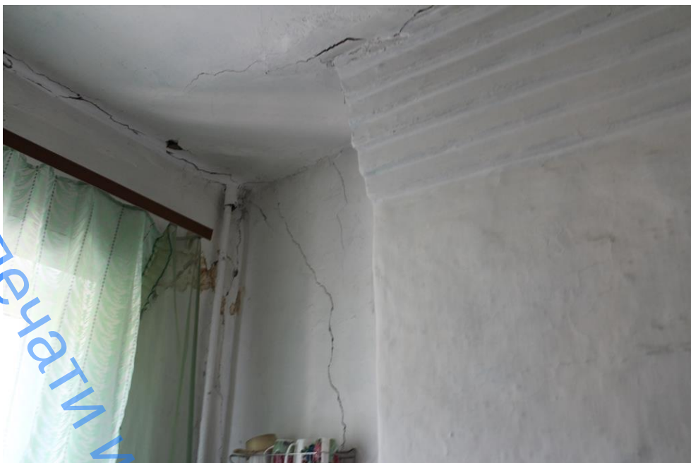
Фото 25. Промерзание по стене Г/5-6 (кв. 7)
