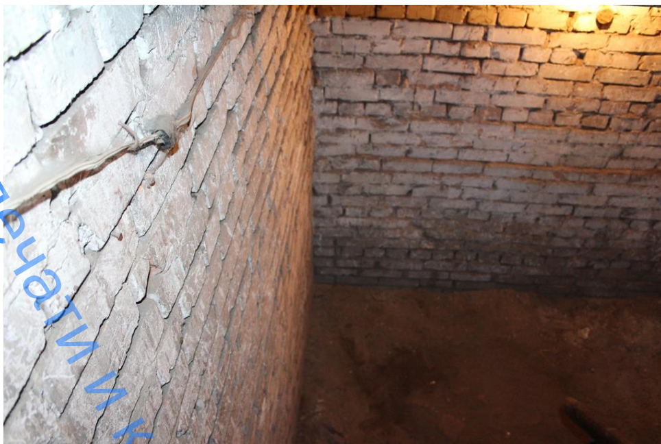
Фото 1. Искривление стен подвала
