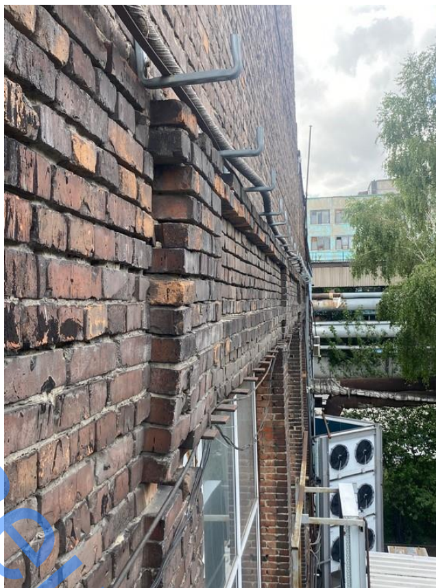
Фото 37 – Выветривание раствора кирпичной кладки, крен участка стены
