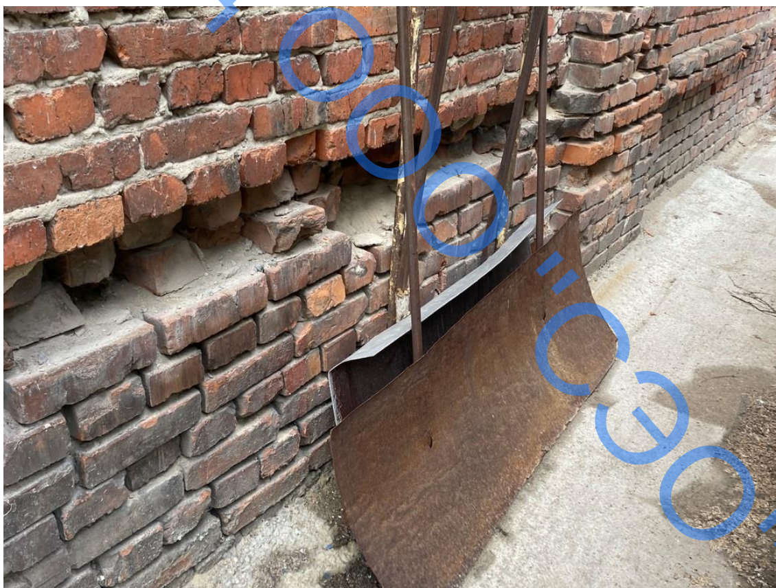
Фото 34 – Вывалы кирпичной кладки, выветривание раствора кирпичной кладки
