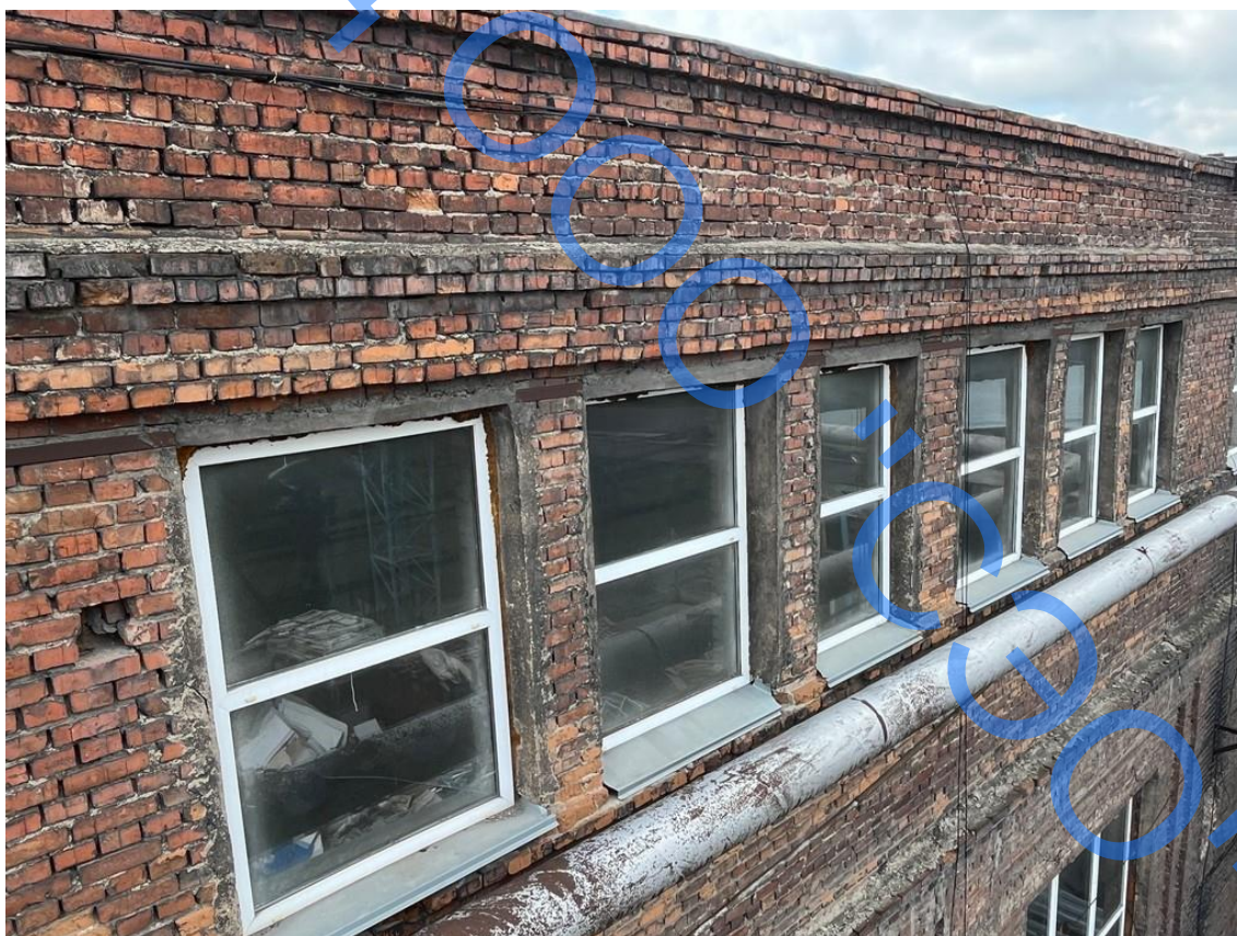
Фото 20 – Вывал кирпичной кладки, разрушение галтели, выветривание раствора кирпичной кладки
