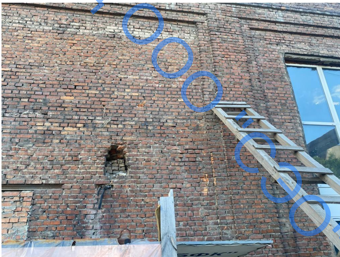
Фото 28 – Вывал кирпичной кладки, выветривание раствора кирпичной кладки
