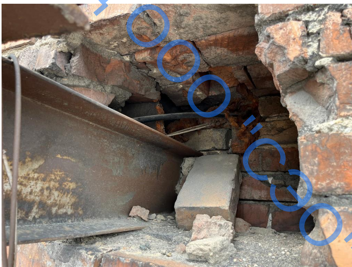
Фото 16 – Вывал кирпичной кладки
