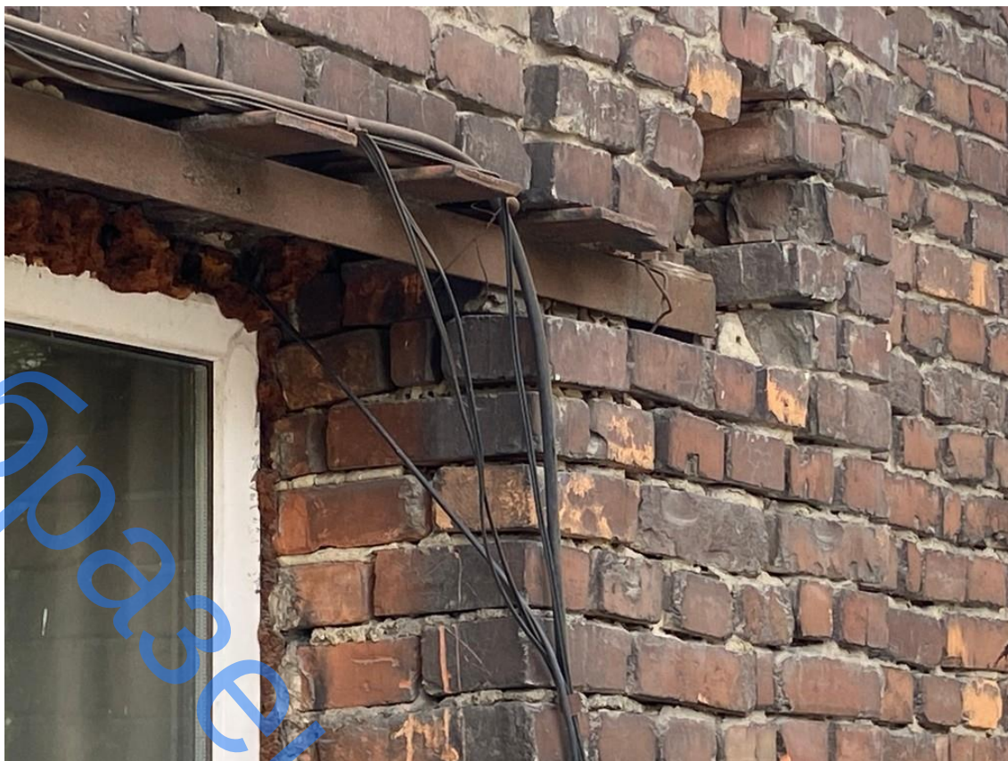
Фото 41 – Выветривание раствора кирпичной кладки, вывалы кирпичной кладки
