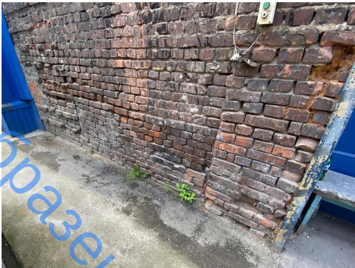
Фото 35 — Вывалы кирпичной кладки, выветривание раствора кирпичной кладки
