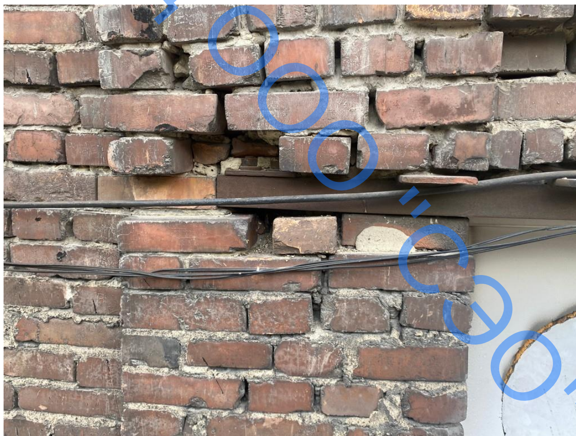
Фото 38 – Выветривание раствора кирпичной кладки, вывалы кирпичной кладки
