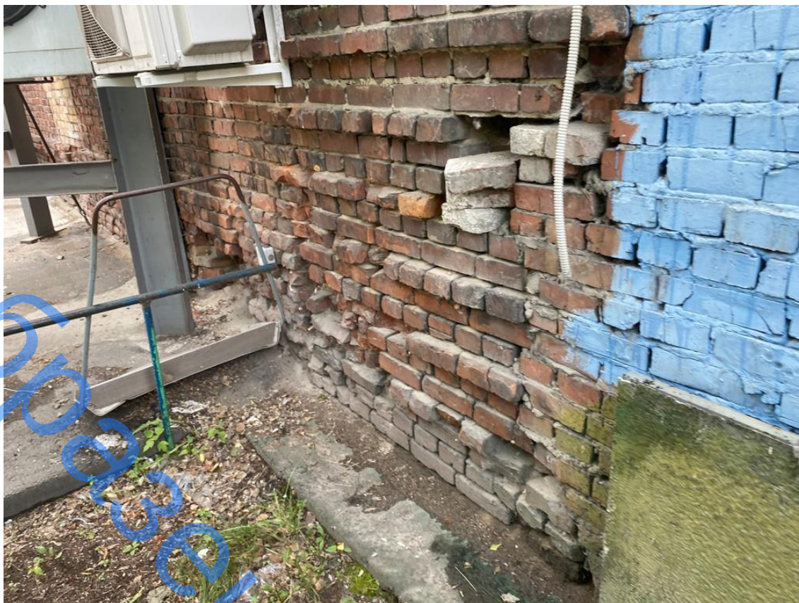
Фото 31 – Вывалы кирпичной кладки, выветривание раствора кирпичной кладки
