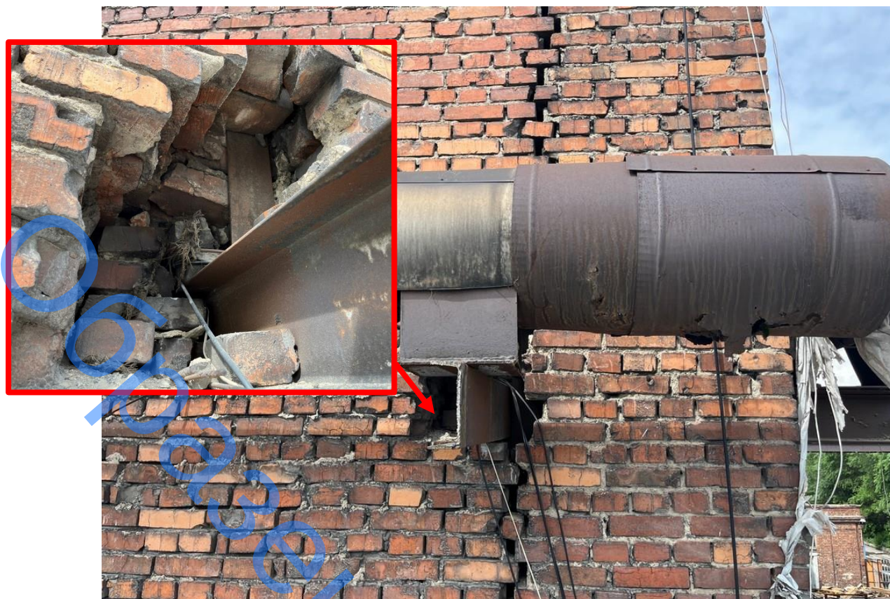
Фото 7 – Вывалы кирпичной кладки
