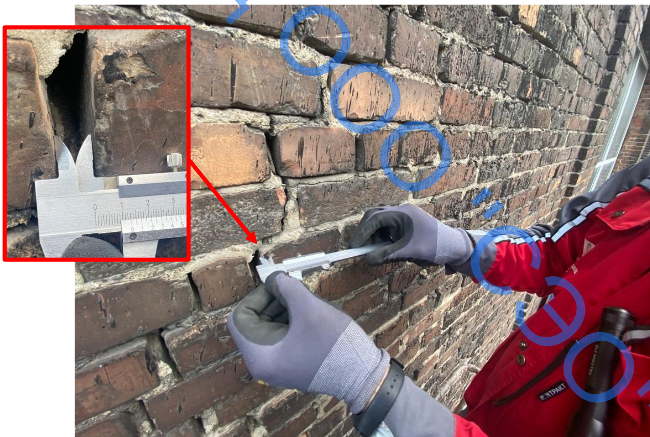
Фото 36 — Трещина по наружной версте стены с шириной раскрытия 13,1 мм
