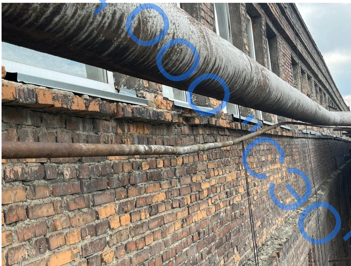
Фото 22 – Вывал кирпичной кладки
