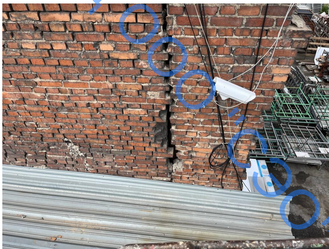
Фото 8 – Вывалы кирпичной кладки
