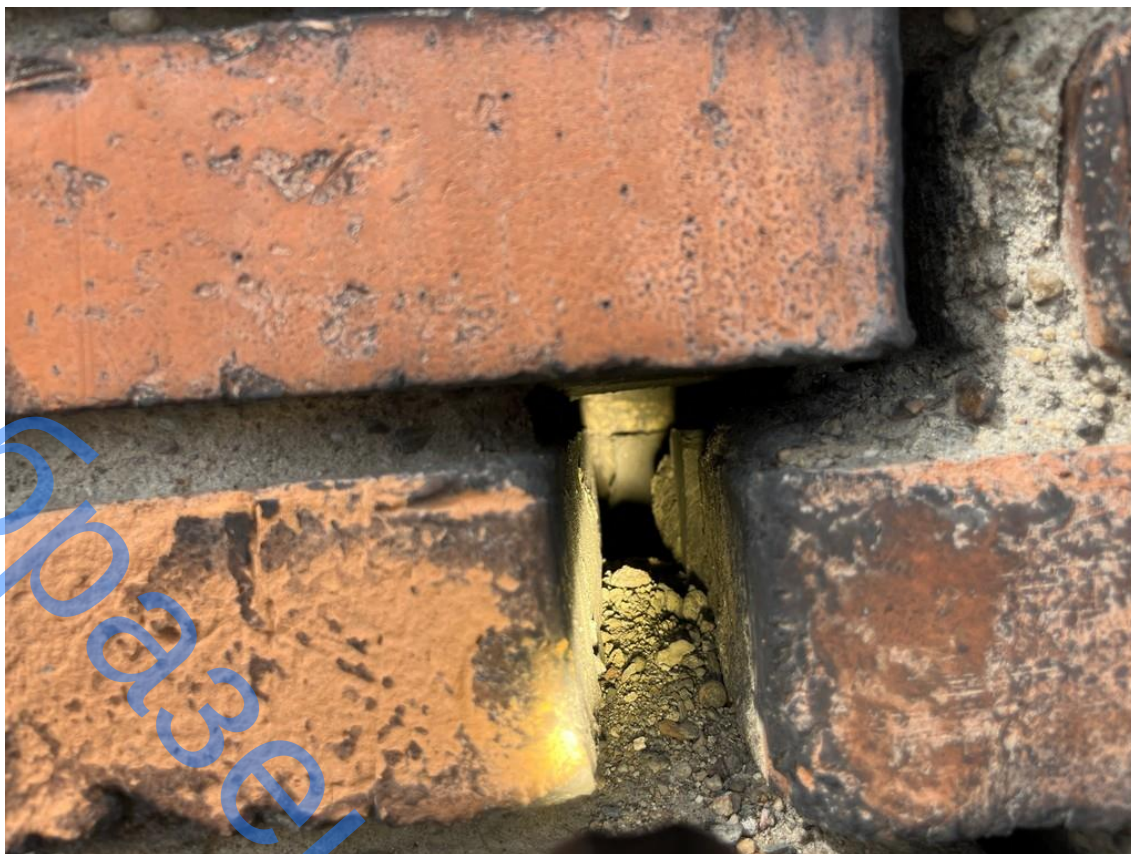
Фото 43 – Отсутствие перевязки кирпичной кладки
