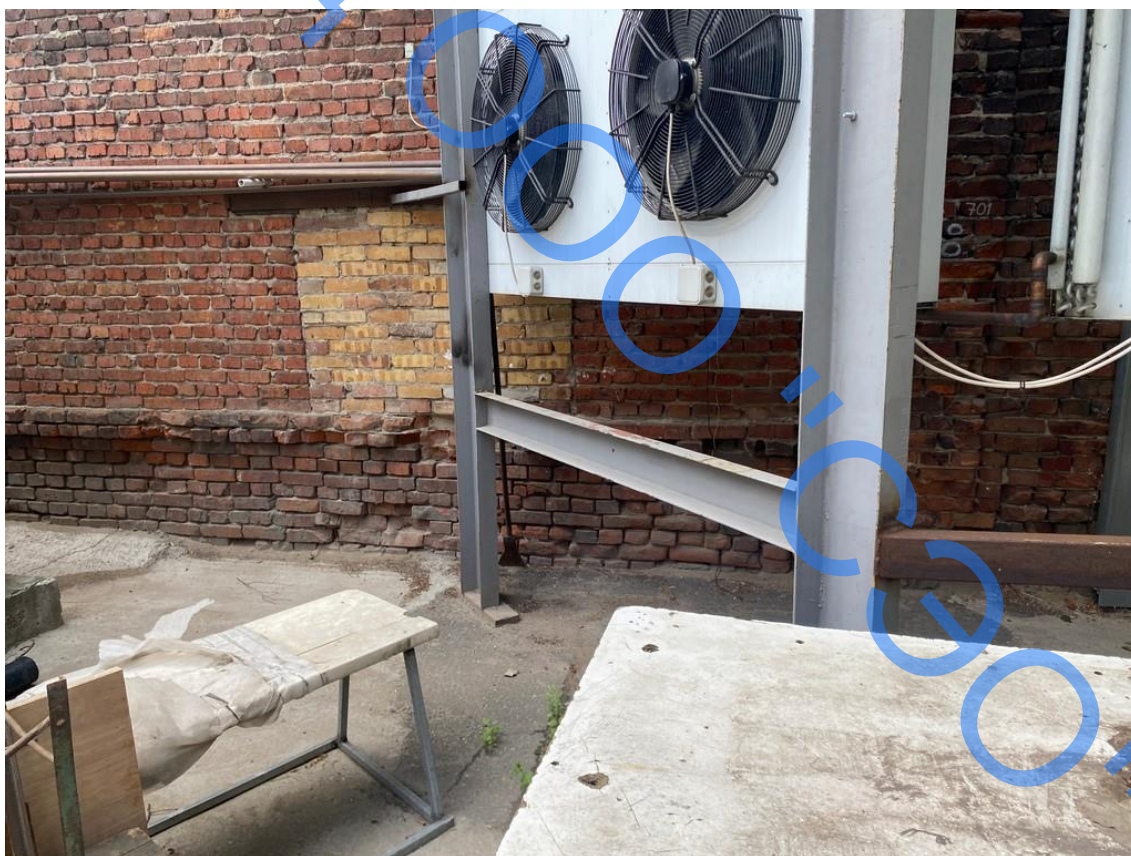
Фото 32 – Вывалы кирпичной кладки, замена участка кирпичной кладки
