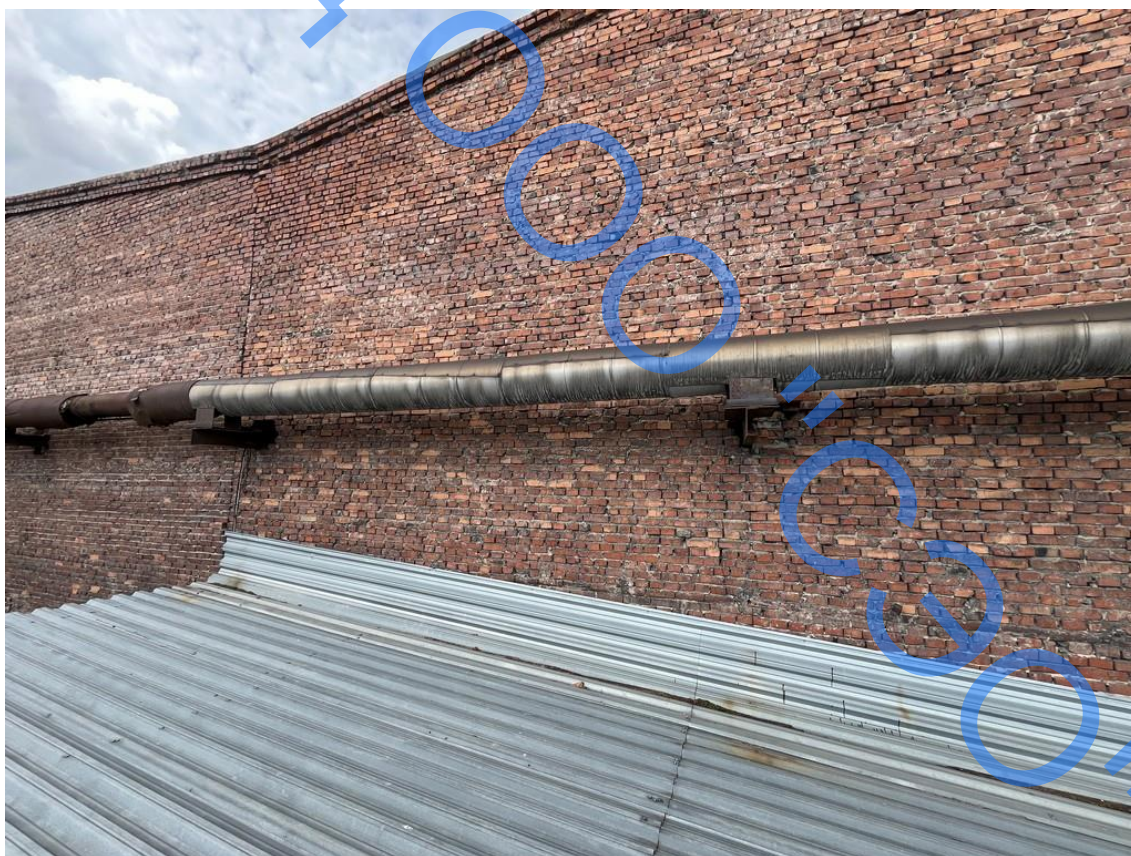
Фото 14 – Вывалы кирпичной кладки
