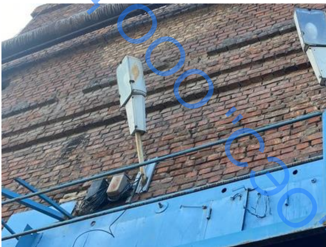
Фото 30 – Вывалы кирпичной кладки, сквозные трещины
