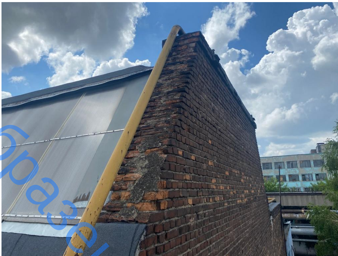
Фото 39 – Разрушение кирпичей кладки стен
