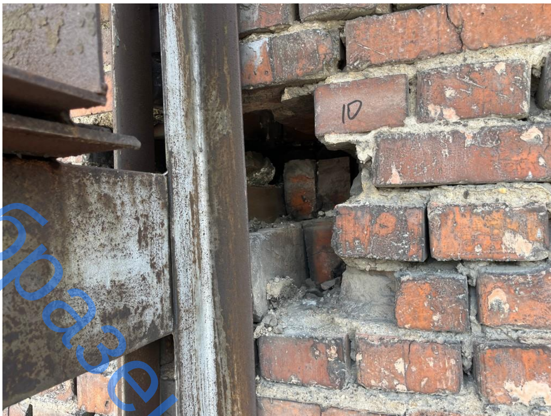
Фото 19 – Вывал кирпичной кладки
