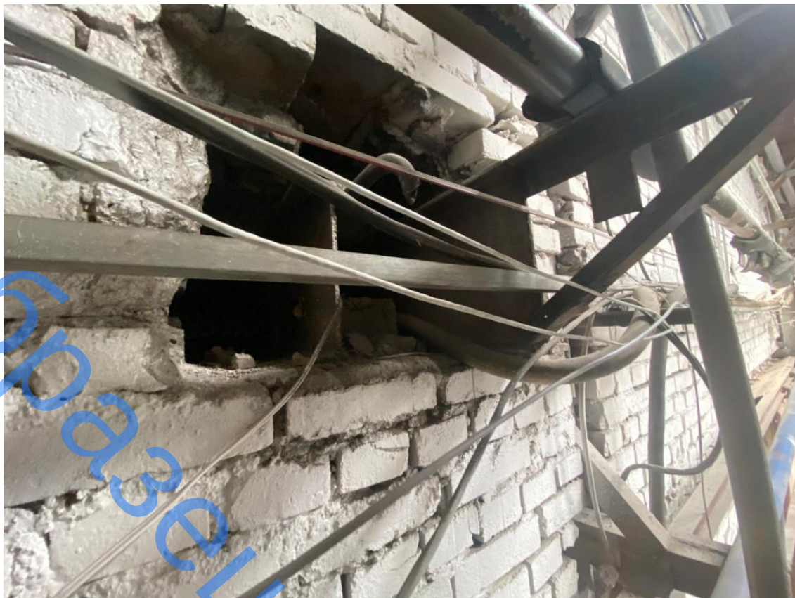
Фото 45 – Опираие балки перекрытия пристройки на кладку стены без опорной подушки или пластины
