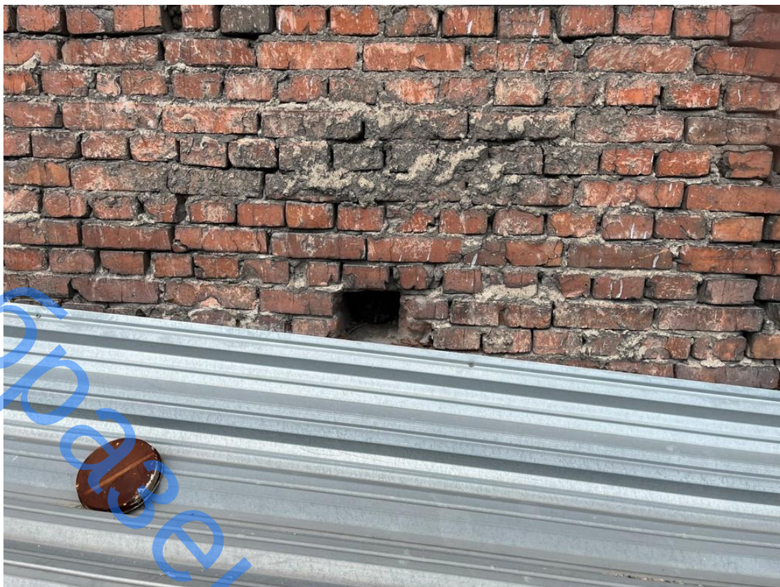
Фото 9 – Вывал кирпичной кладки
