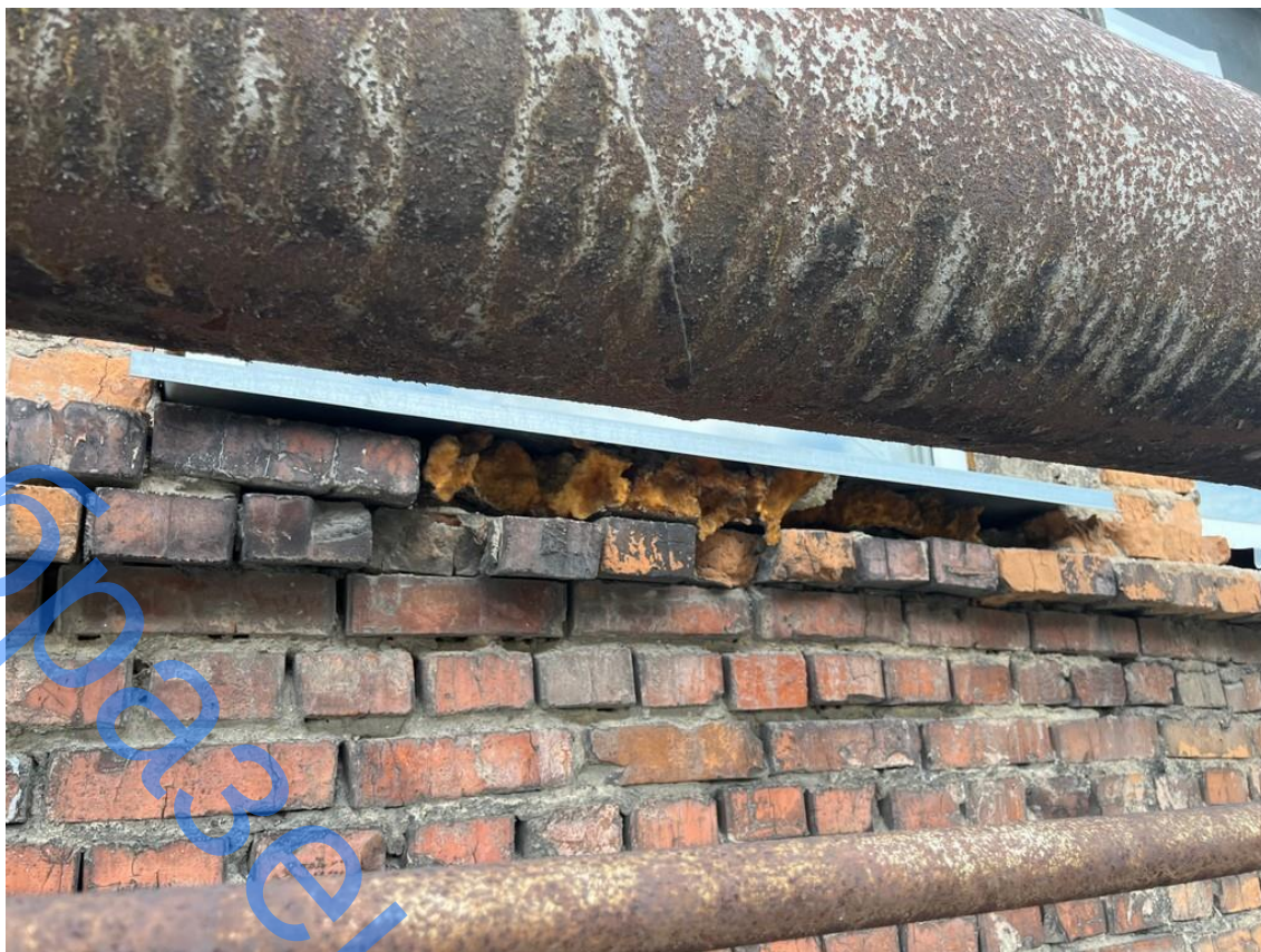
Фото 21 – Вывал кирпичной кладки
