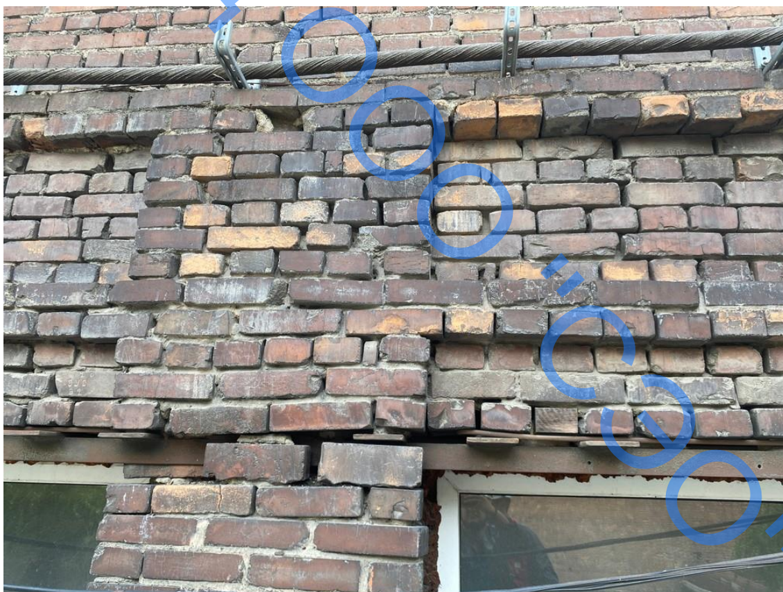
Фото 40 – Выветривание раствора кирпичной кладки, вывалы кирпичной кладки
