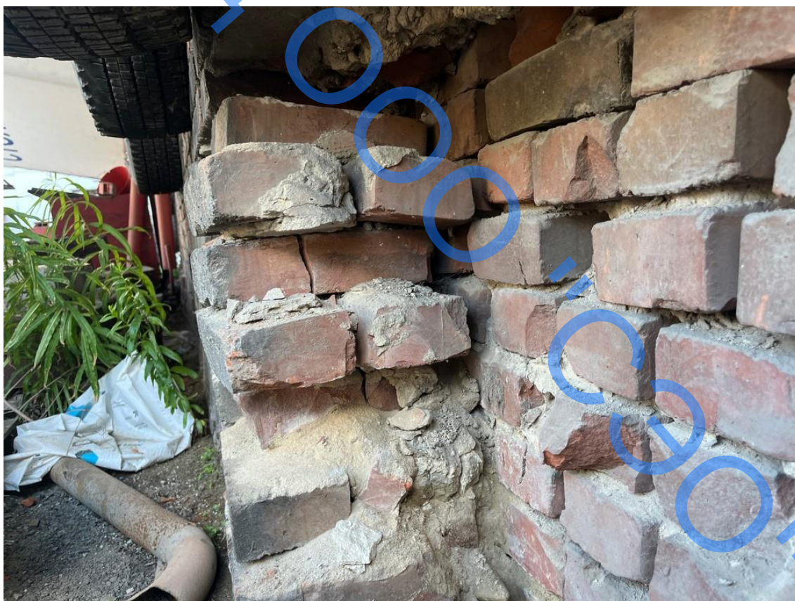
Фото 42 – Отсутствие перевязки кирпичной кладки
