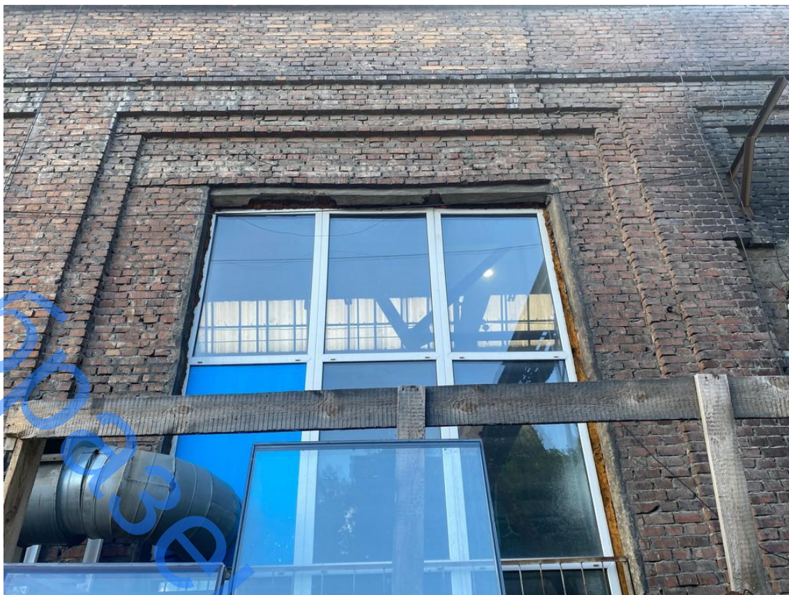
Фото 25 – Разрушение железобетонной оконной перемычки
