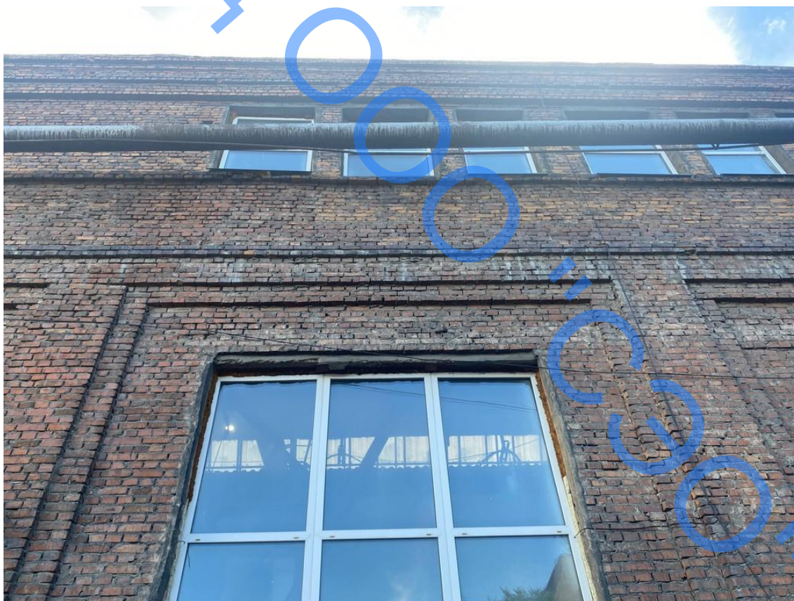
Фото 26 – Разрушение железобетонной оконной перемычки
