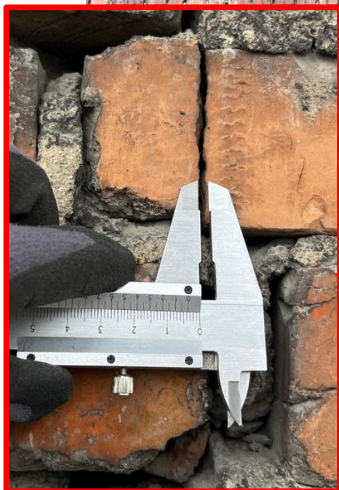
Фото 12 – Вывал кирпичной кладки, сквозная трещина с шириной раскрытия от 3,7 мм
