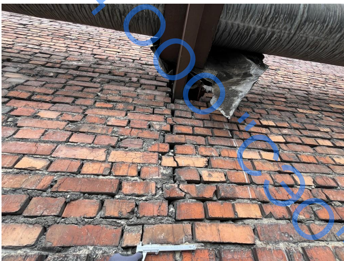
Фото 10 – Вывал кирпичной кладки, сквозная трещина с шириной раскрытия 6,1 мм
