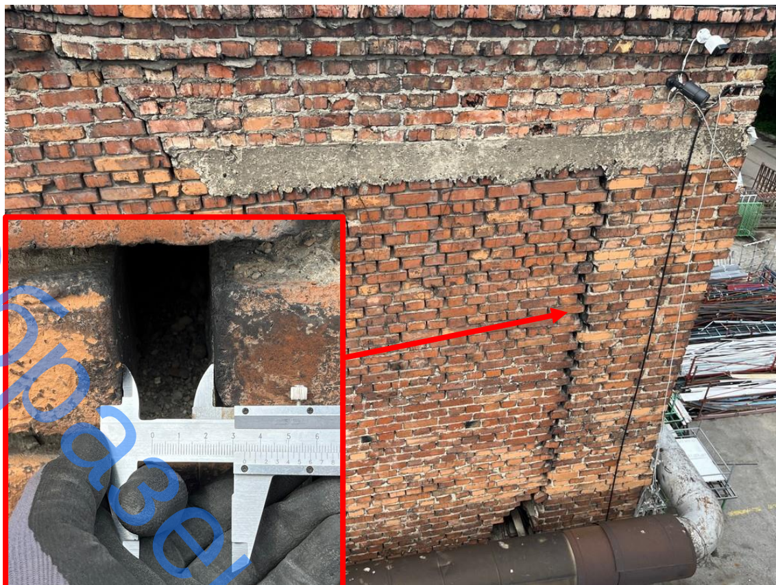
Фото 5 – Сквозная трещина с шириной раскрытия до 34,4 мм
