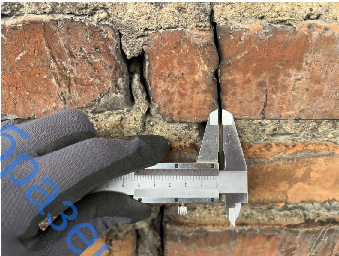
Фото 15 – Сквозная трещина с шириной раскрытия 2,8 мм
