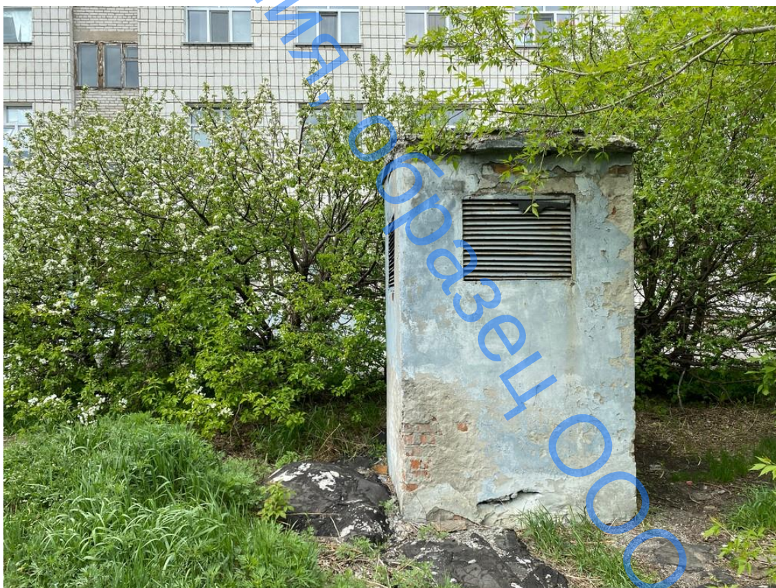
Фото 8 – Общий вид вентшахты приточной системы вентиляции
